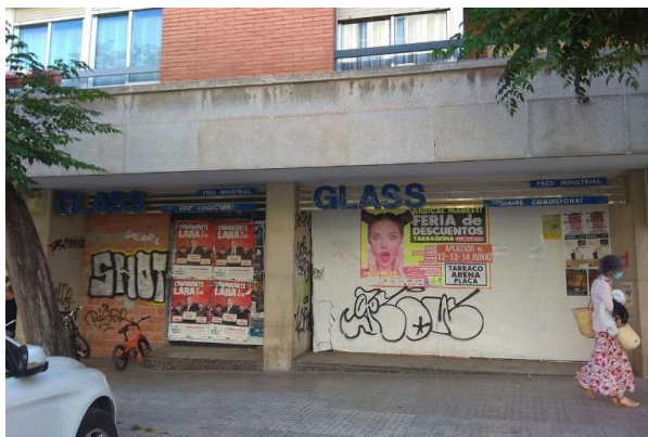
Local tancat i en mal estat Av. Catalunya
