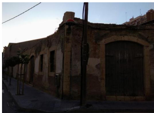
Magatzem en desús i mal estat
