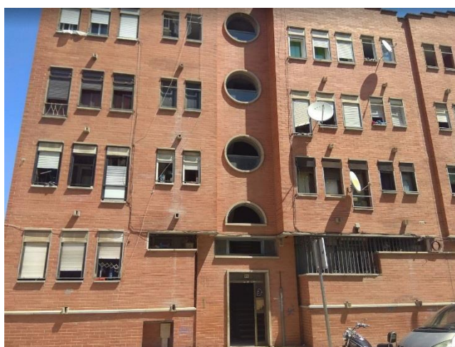
Blocs de pisos en mal estat
