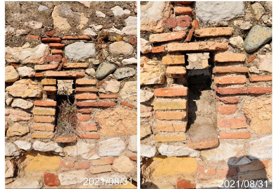
Fig. 24. Exemple de neteja de vegetació que millora el funcionament de sistemes d'evacuació d'aigua del pas de ronda de la muralla
