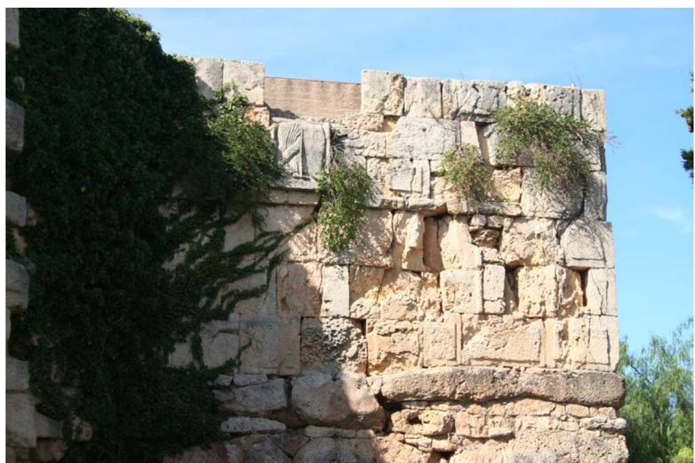
A1 29 – Els problemes estructural i de degradació de la cantonada de la torre de Minerva posen en perill la seva preservació de manera adient .
