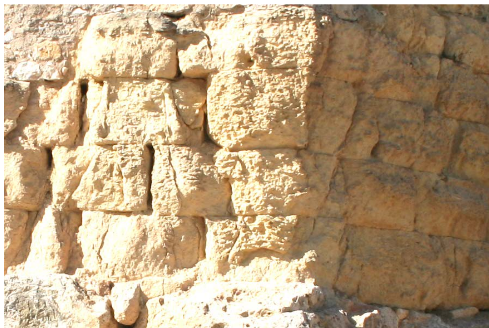
A1 16 – Carreus de pedra del Llorito a la muralla amb un estat degradació elevada.
