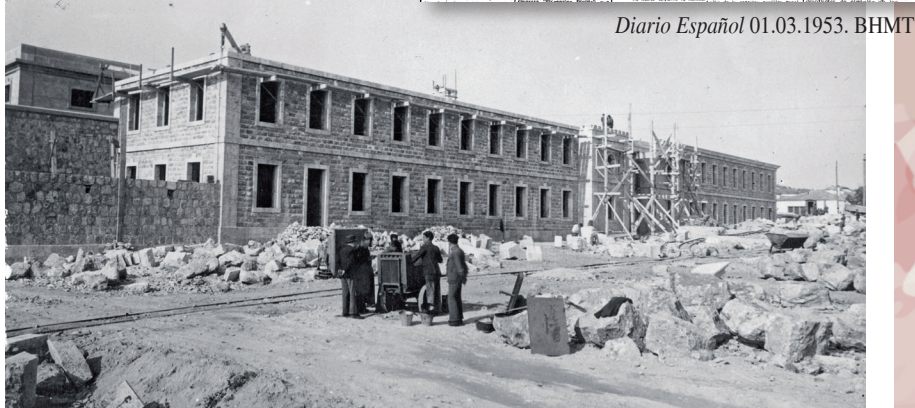
Obres de construcció de la presó provincial. 1949. Foto Chinchilla. Centre d'Imatges de Tarragona / L'Arxiu.
