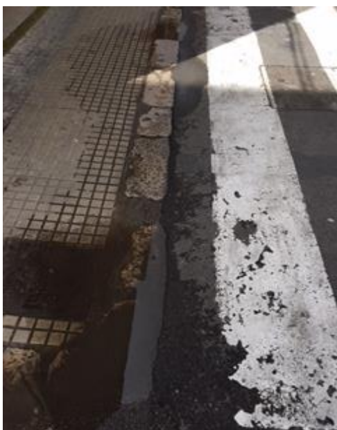
Vorera i calçada en mal estat i acumulació d'aigua.
