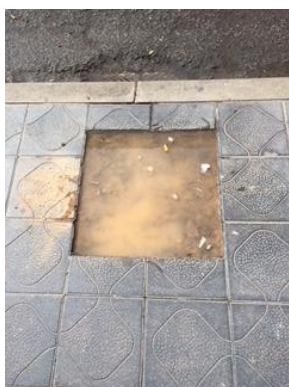
Forats dels arbres al mig de les voreres.
