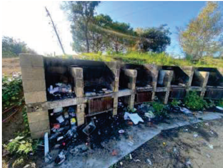
Estat actual de degradació de la zona de les barbacoes del parc.
