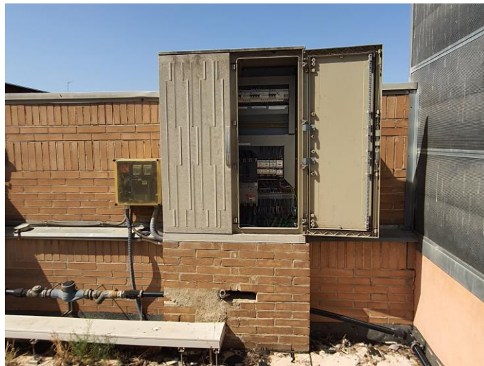
Caixa de distribució elèctrica existent de coberta, on trobem el baixant existent
