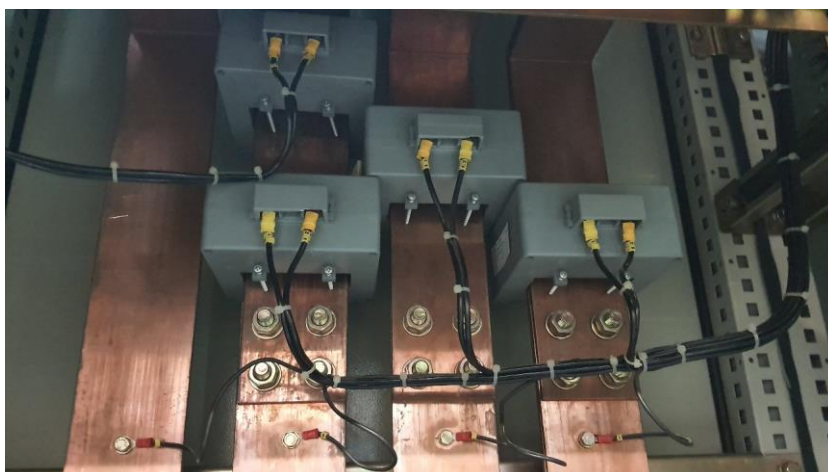
Punt de connexió abans del grup electrogen i de la mesura de la potència reactiva.
