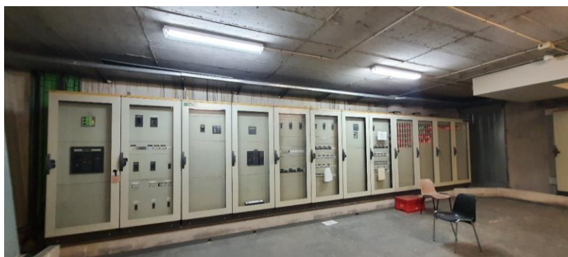
Recinte on trobem la caixa de distribució elèctrica general situada al palau de congressos
