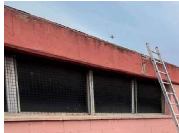
Cornisa superior coberta deteriorada.
