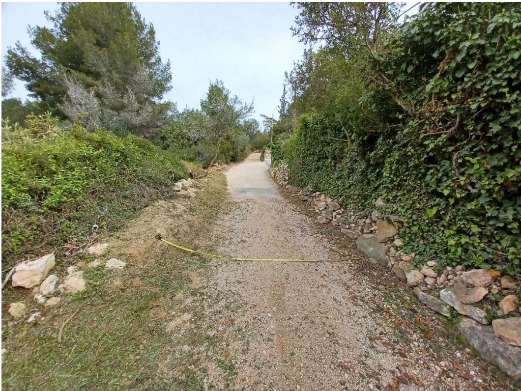
FOTO Nº 12. Vista del pas del tram estret del camí nou de la Budellera, on s'hi troben murs de pedra seca amb possible afectació.
