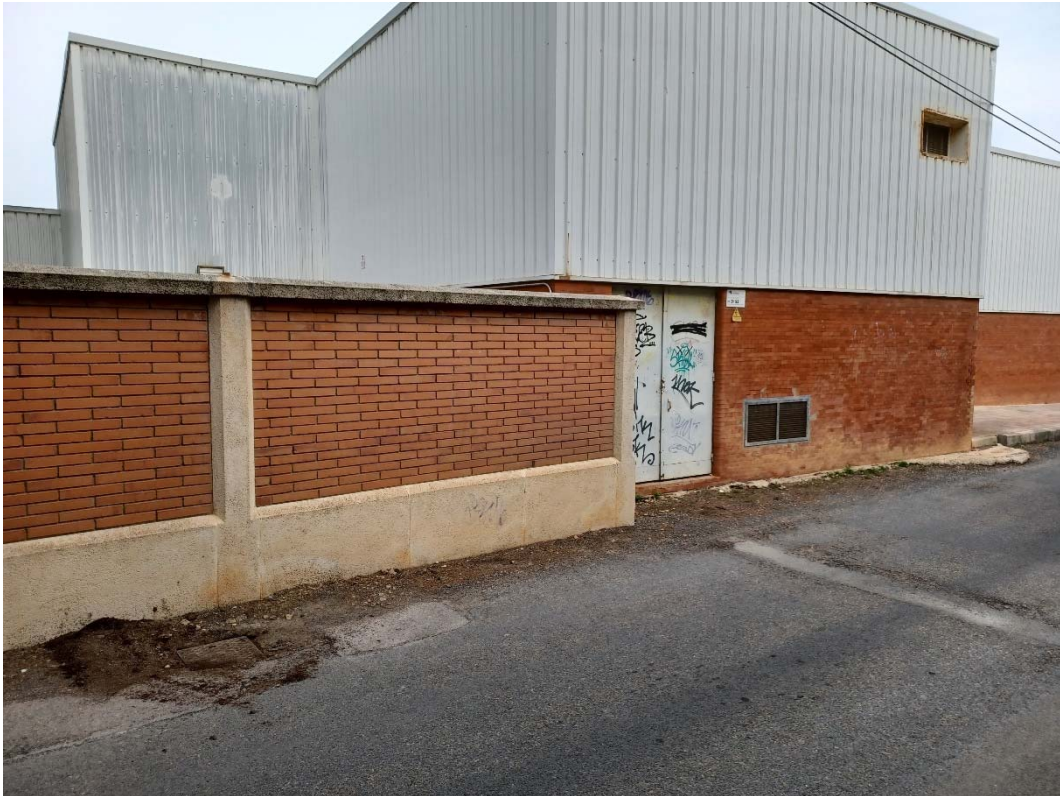
FOTO Nº 7. Vista de la E.T. i de la zona per on entra el circuit de MT que l'alimenta, situada en l'extrem nord de la parcel·la del CIDO.
