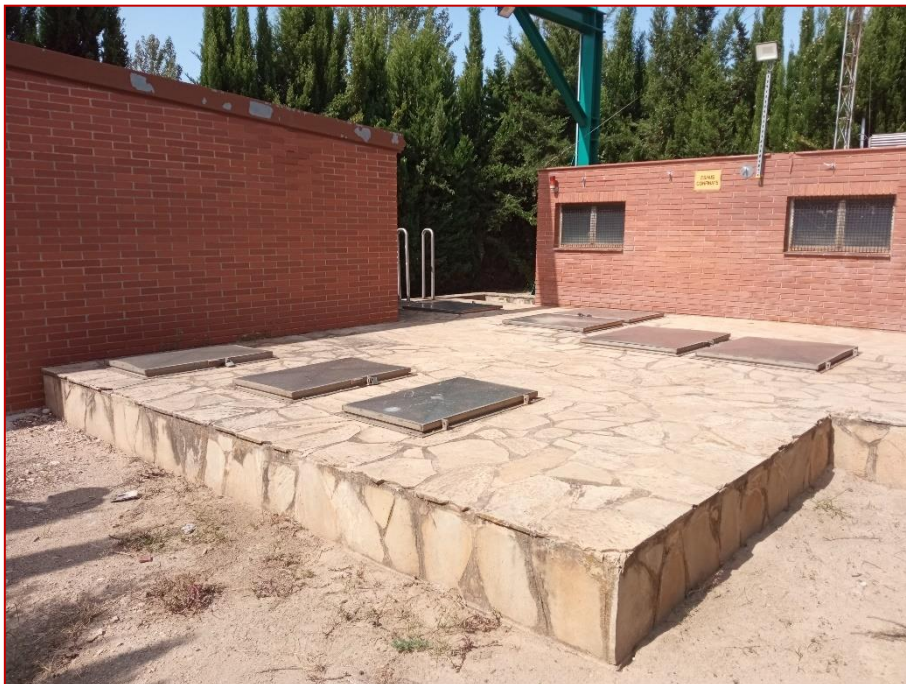
Fotografia nº 4: Arquêtes i trapes de l'actual EB La Mora i caseta canonada entrada i quadres elèctrics.
