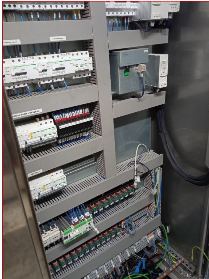
Fotografia nº 6: Quadre elèctric existent en les instal·lacions de l'actual Estació de Bombament.
