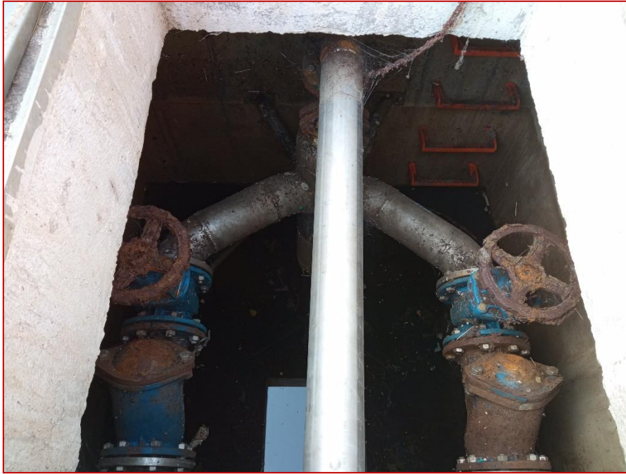
Fotografia nº 5: Cambra de vàlvules de les canonades d'impulsió de l'emissari submergi.
