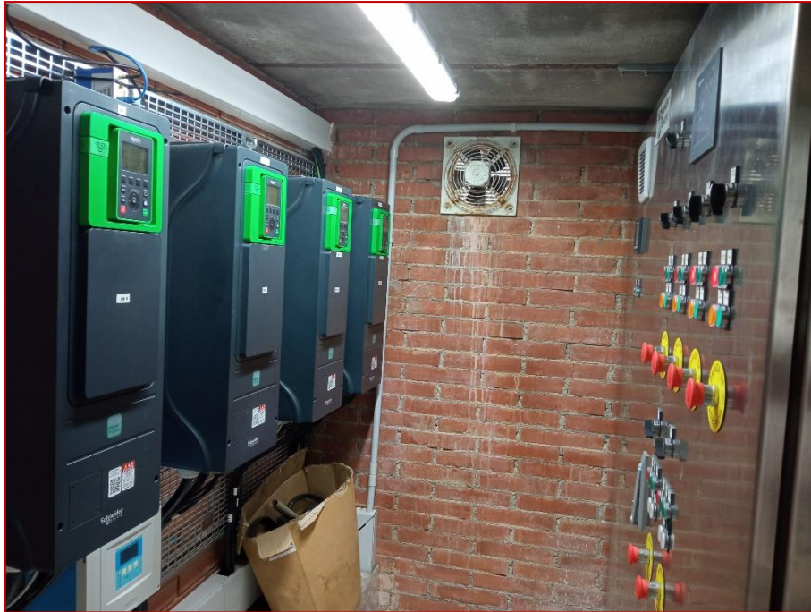
Fotografia nº 7: Sala de quadres elèctrics amb els quadres i variadors de freqüència de les bombes actuals.
