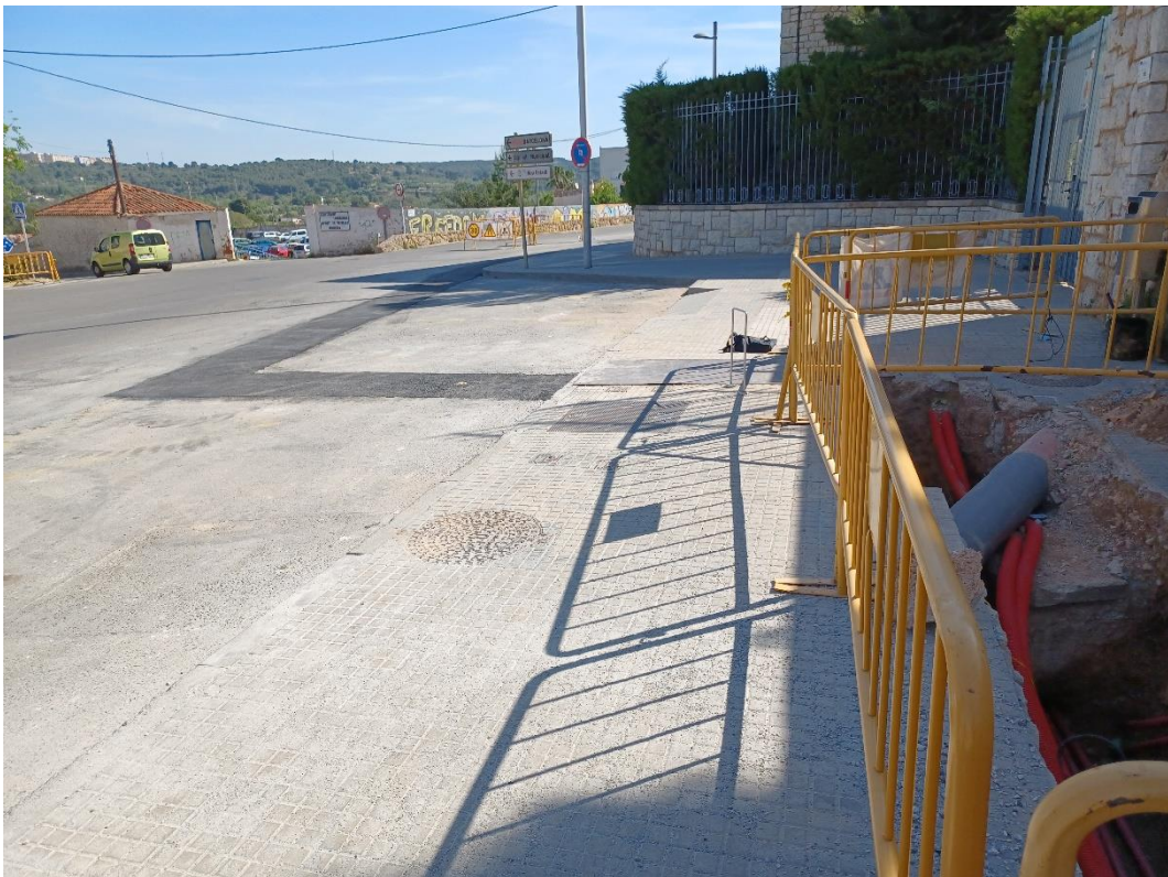
FOTO Nº 4. Vista de la Av. Maria Cristina, zona connexió nova canonada FD DN400 de la zona d'actuació nº2.
