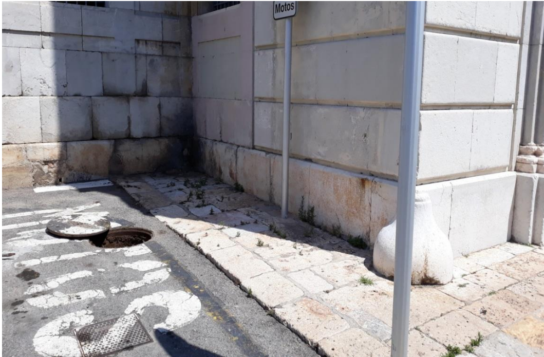
FOTO N° 21: Vista Carrer Guitarra cantonada amb Pla de Palau. Arqueta amb vàlvula de papallona existent. Zona d'actuació n°3.
