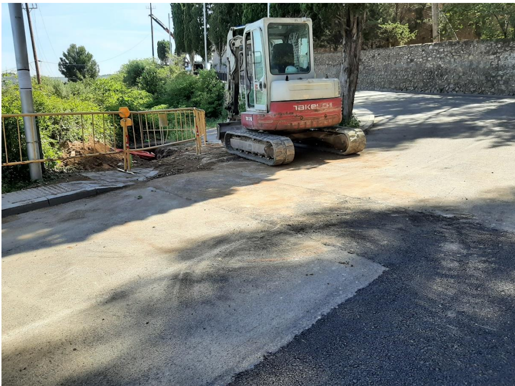
FOTO N° 10. Vista del tram de calçada del Passeig de Torroja on el traçat de la línia elèctrica de MT de 25kV es desvia cap a l'exterior del vial.
