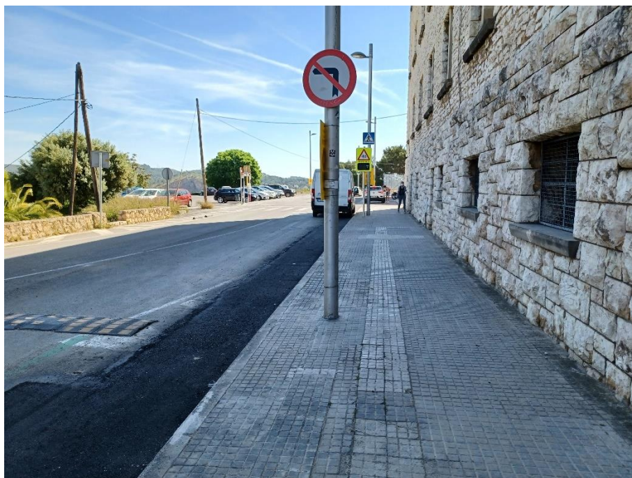
FOTO Nº 6. Vista transversal del Passeig de Torroja, on es pot observar la rasa asfaltada del traçat de la nova línia de MT de 25kV instal·lada.
