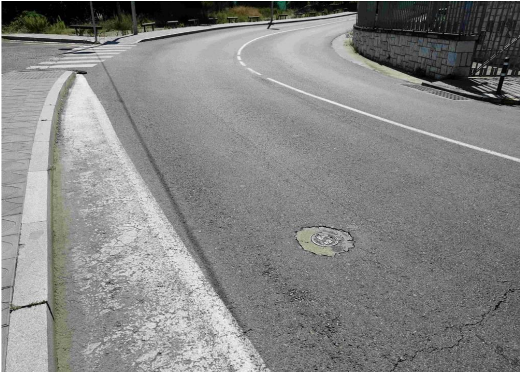
FOTO N° 7. Vista Passeig de Torroja, vista d'alguns dels serveis existents a l'àrea d'obres, com és una vàlvula en calçada corresponent al servei de gas.
