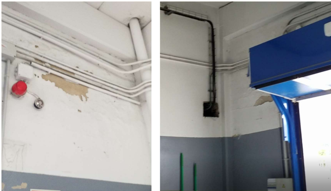
Foto 4 Desperfectes en revestiment interior.
