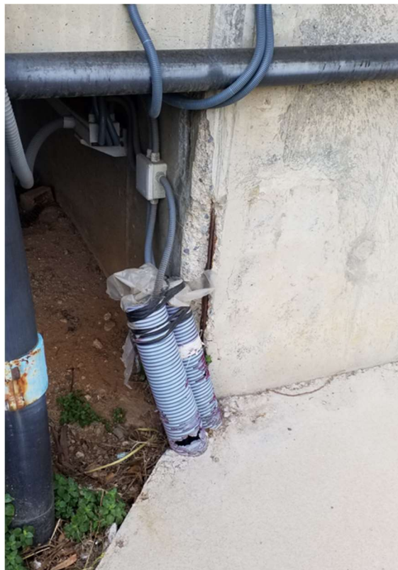
Foto 23 Descantells i corrosió de les armadures
