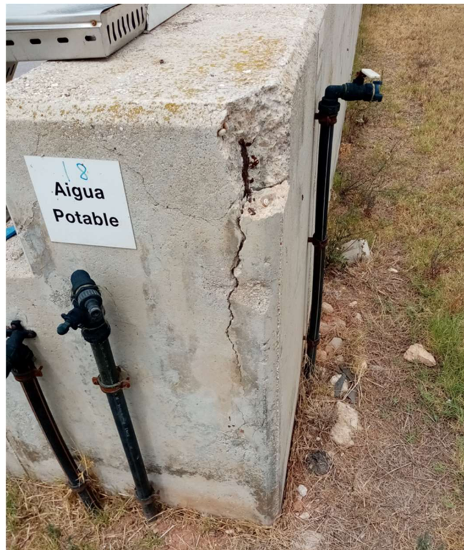
Foto 37 Descantells i corrosió de les armadures
