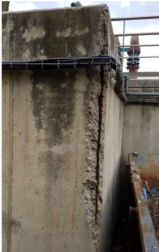
Foto 25 Descantellats i corrosió de les armadures
