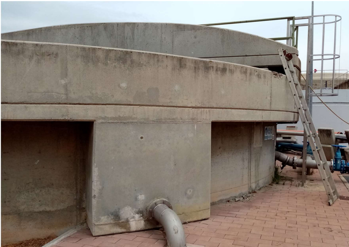
Foto 3 Canvis de coloració del formigó
