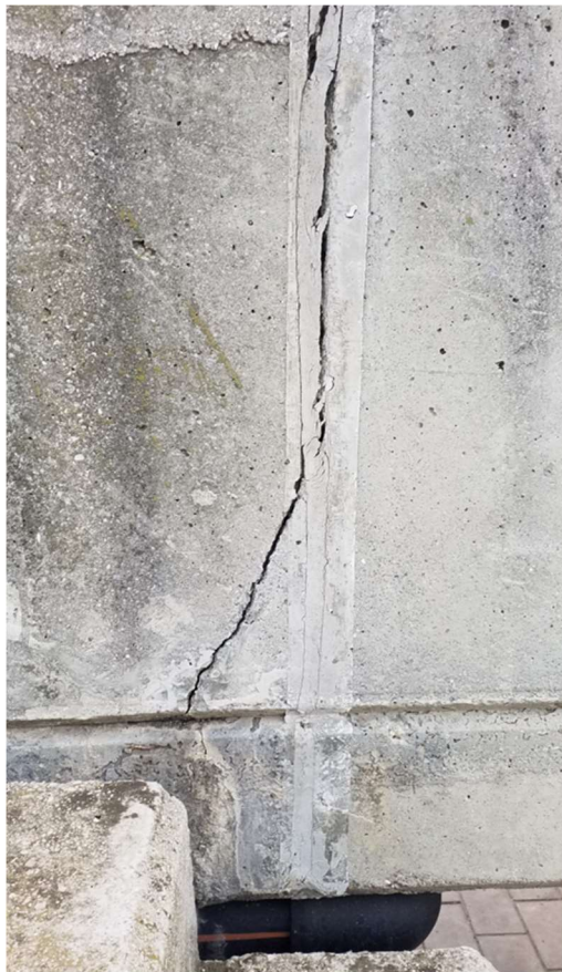
Foto 29 Obertura de juntes i fissures
