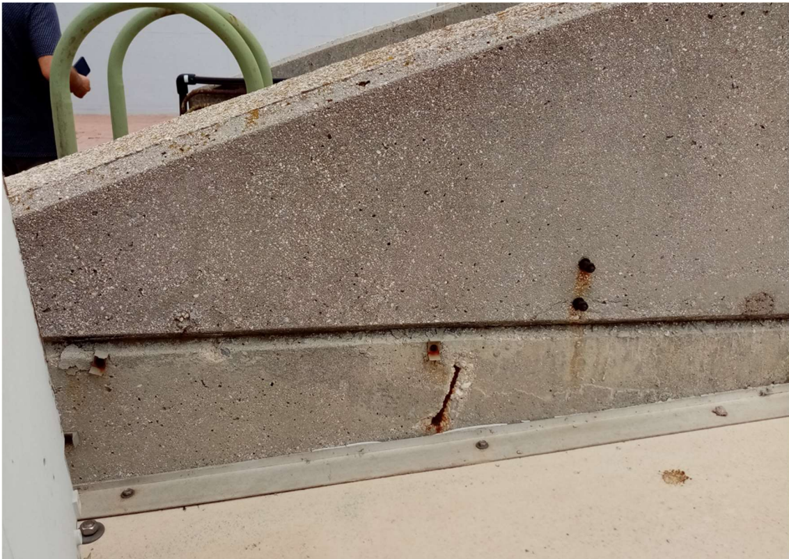
Foto 17 Corrosió de les armadures
