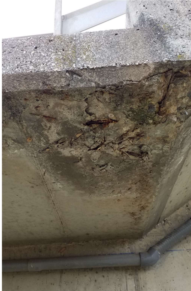
Foto 24 Coqueres i corrosió de les armadures
