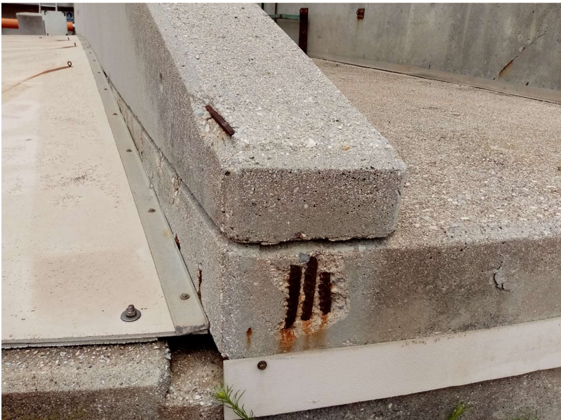
Foto 18 Descantells i corrosió de les armadures
