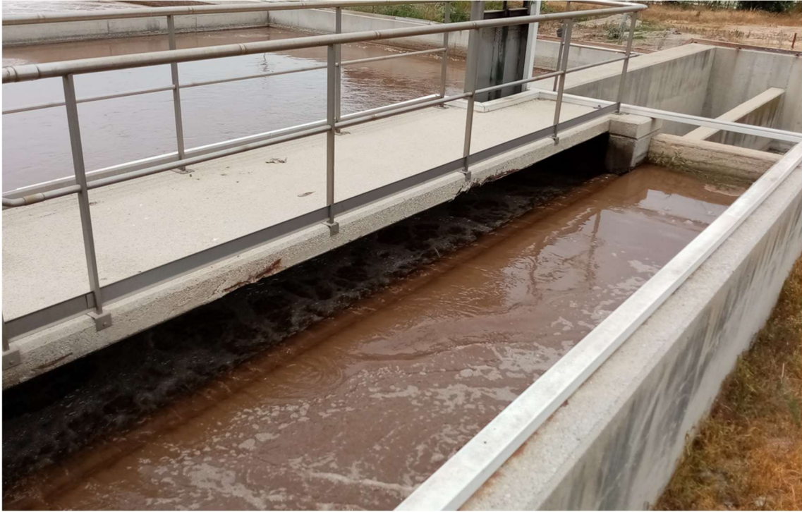
Foto 38 Foto 23 Descantells i corrosió de les armadures
