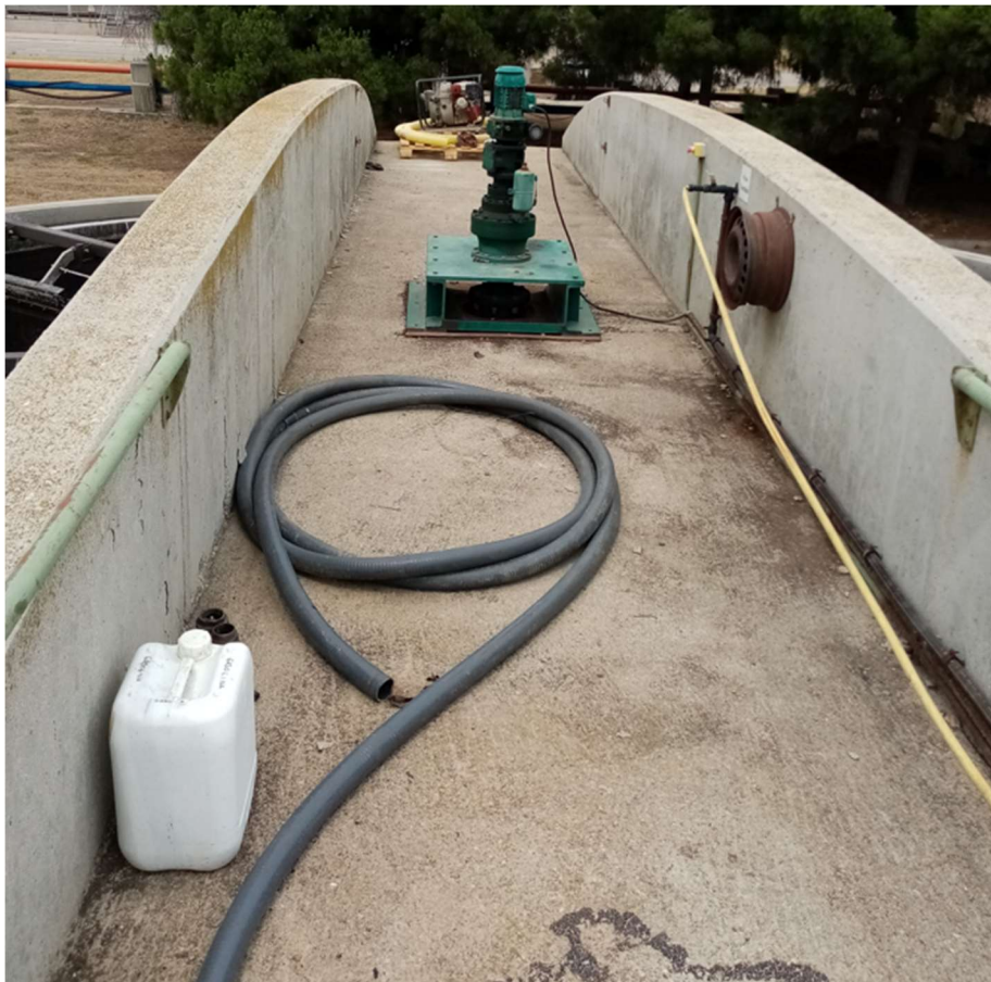
Foto 2 Canvis de coloració del formigó
