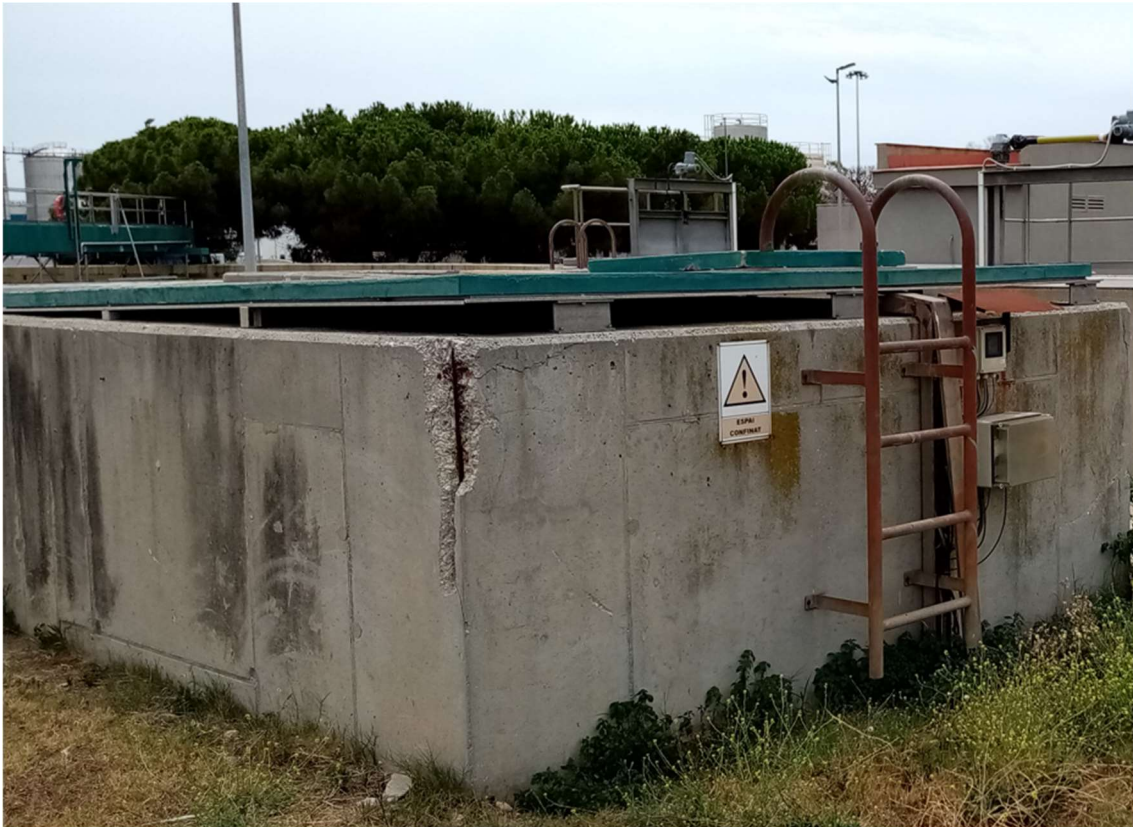
Foto 30 Descantellats i corrosió de les armadures
