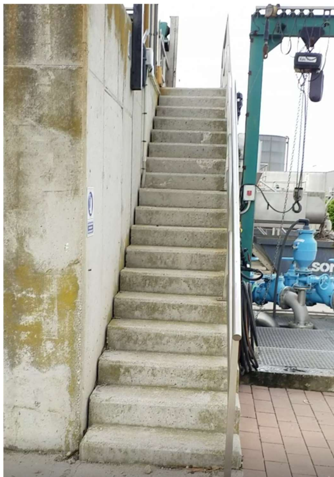
Foto 21 Canvis de coloració del formigó
