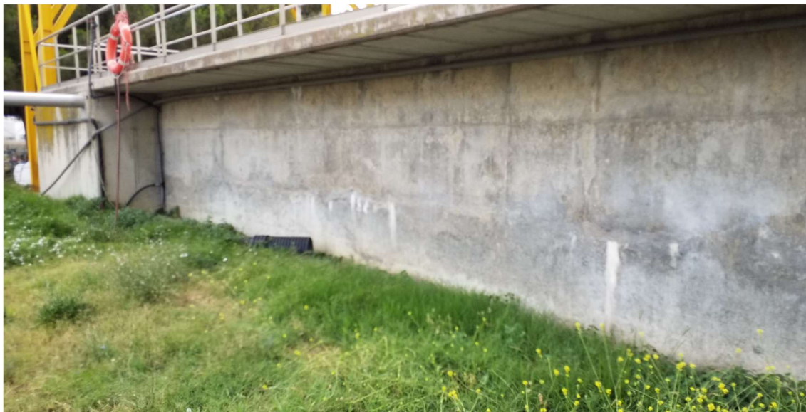
Foto 20 Canvis de coloració del formigó
