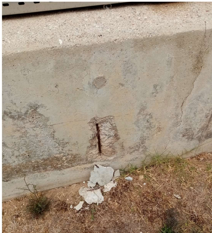
Foto 35 Desconxats i corrosió de les armadures
