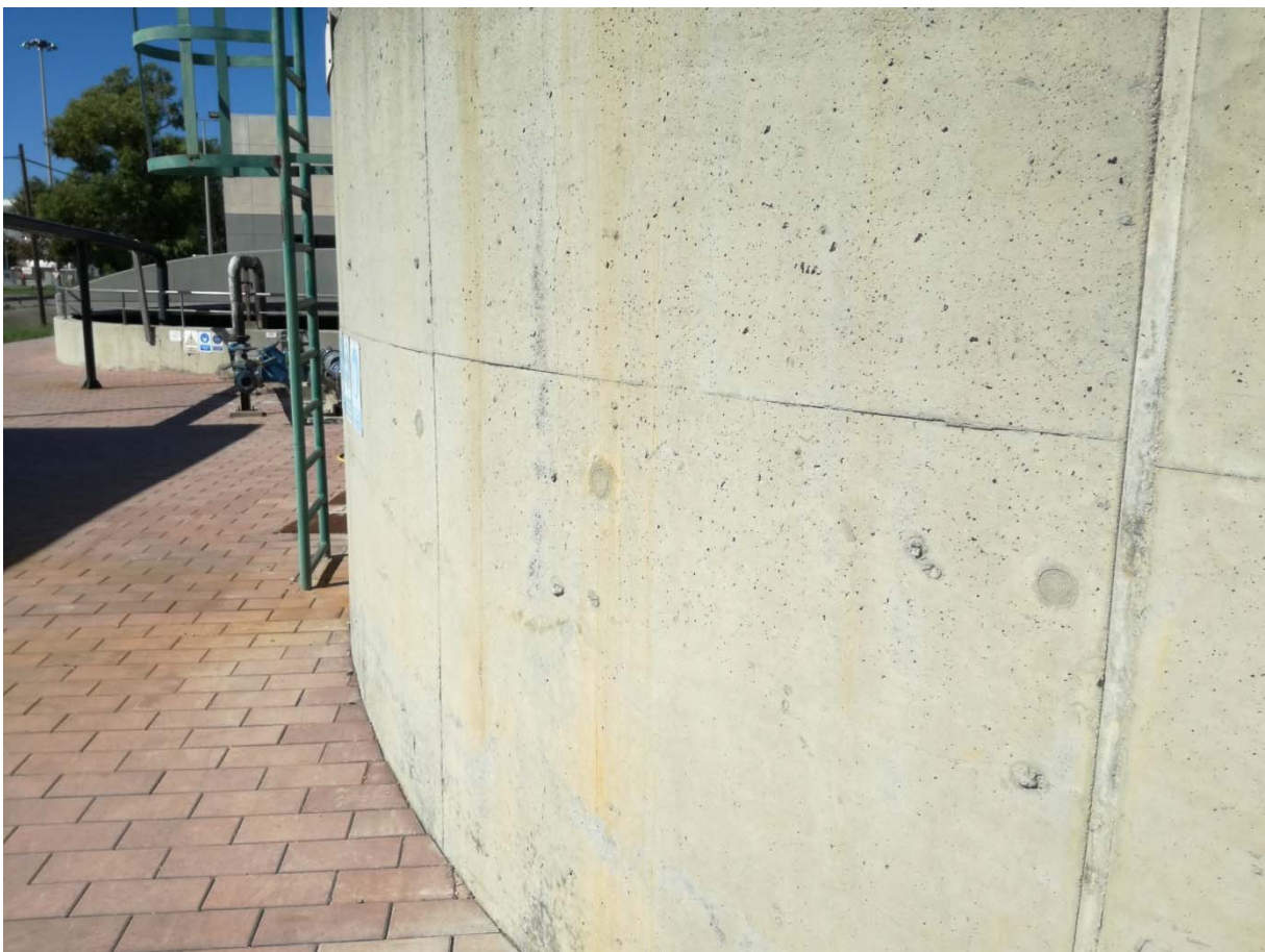
II. ANNEXOS Annex 1. Reportatge fotogràfic Estudi de patologies línia de fangs EDAR de Tarragona
