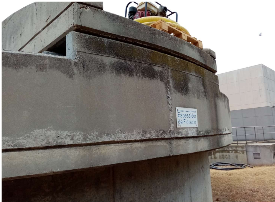
Foto 1 Canvis de coloració del formigó i descantellats
