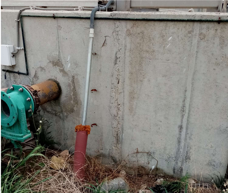
Foto 36 Filtracions, desgast del formigó/coqueres
