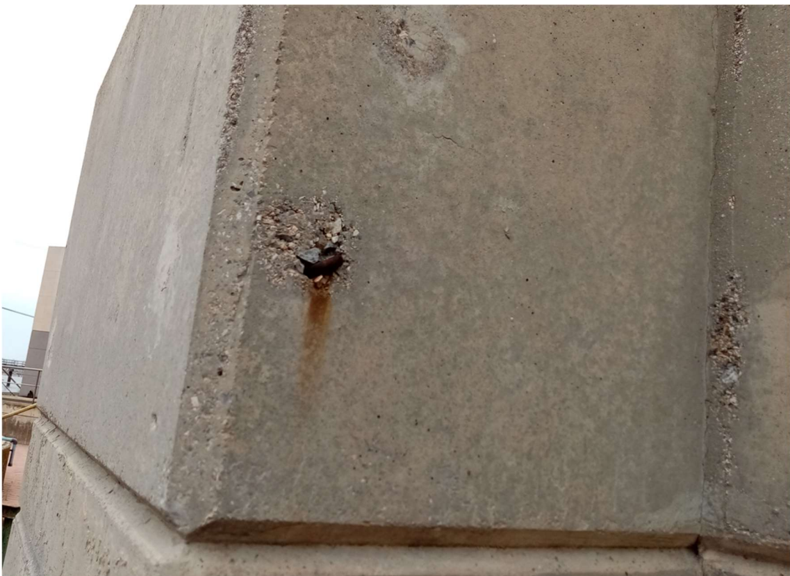
Foto 16 Coques i corrosió de les armadures
