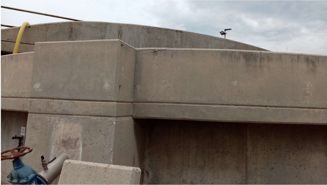
Foto 13 Canvis de coloració del formigó
