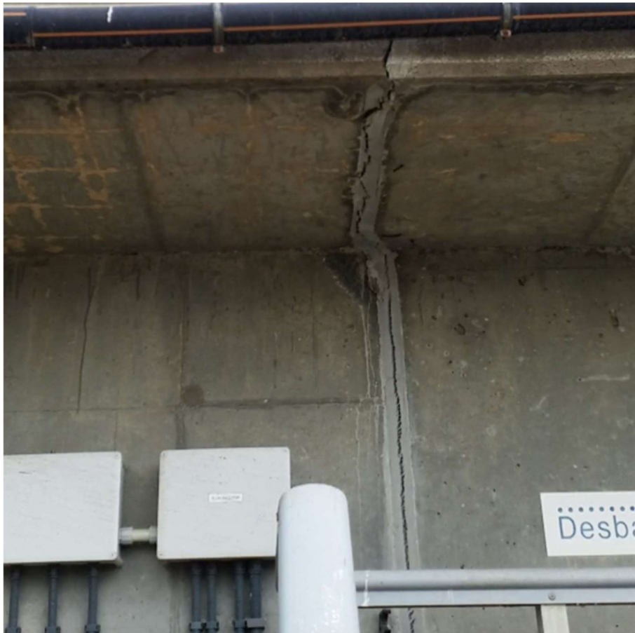
Foto 27 Obertura de juntes
