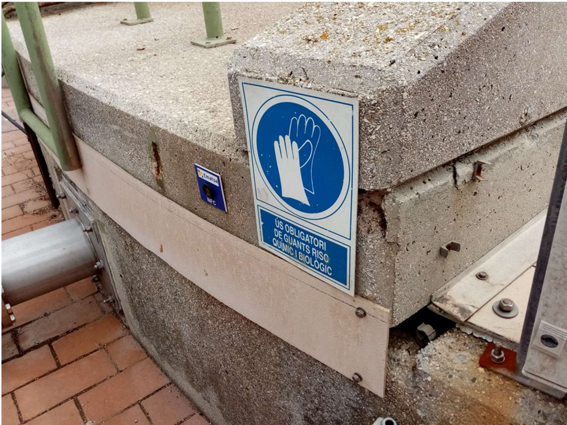
Foto 19 Descantells i corrosió de les armadures
