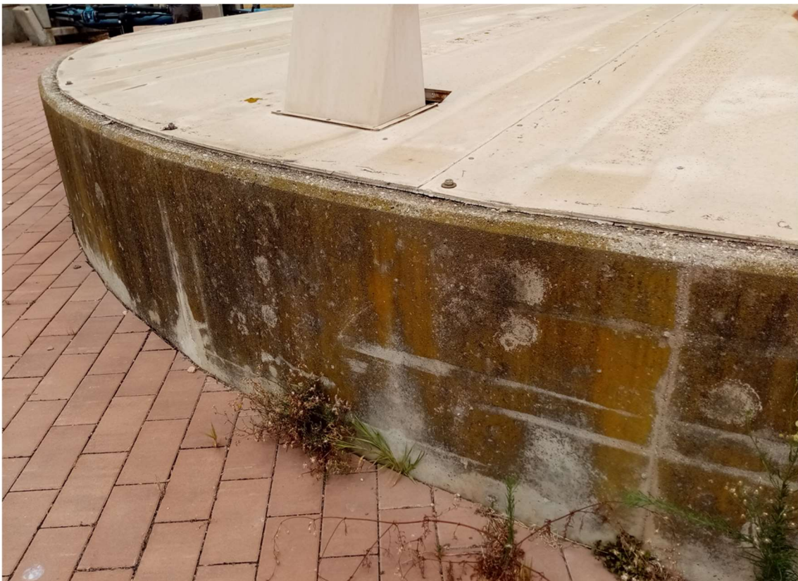
Foto 12 Canvis de coloració del formigó
