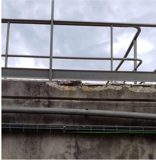
Foto 26 Descantellats i corrosió de les armadures
