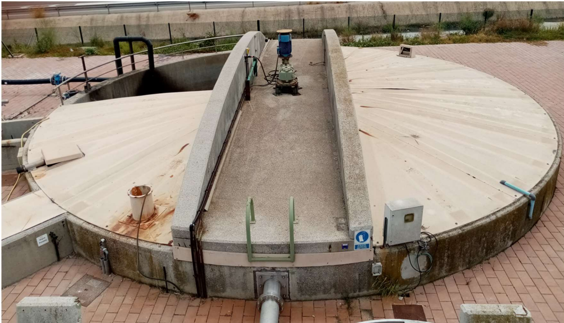
Foto 11 Canvis de coloració del formigó
