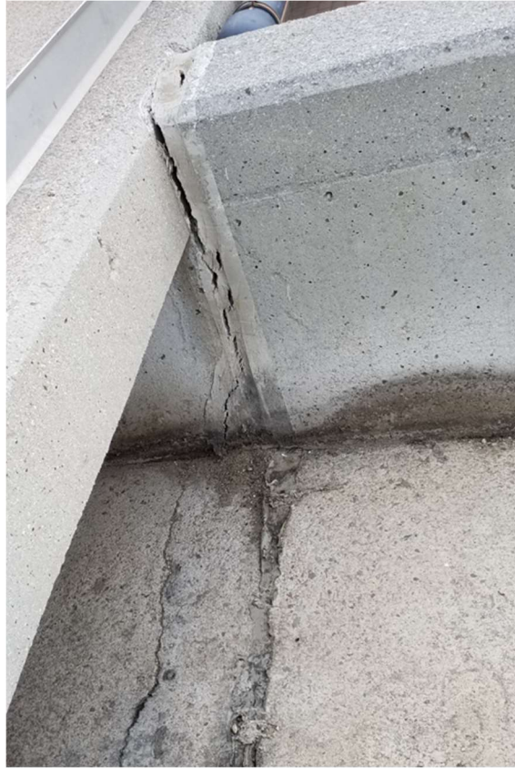
Foto 28 Obertura de juntes i fissures
