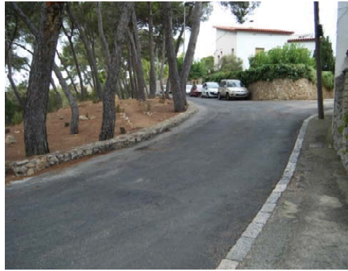
FOTO 2: Vista de la calçada tipus de paviment asfàltic, per on anirà el segon tram de la nova canonada.
