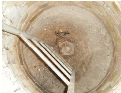
FOTO 4: Vista de la vàlvula de papallona existent en zona de terres, la maniobra de la qual es mantindrà amb la present actuació.
