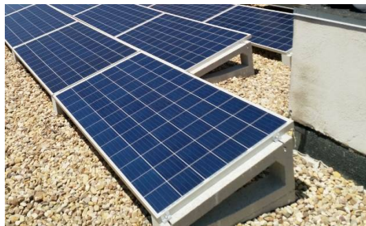
Ilustración 5. Soporte fotovoltaico utilizado
