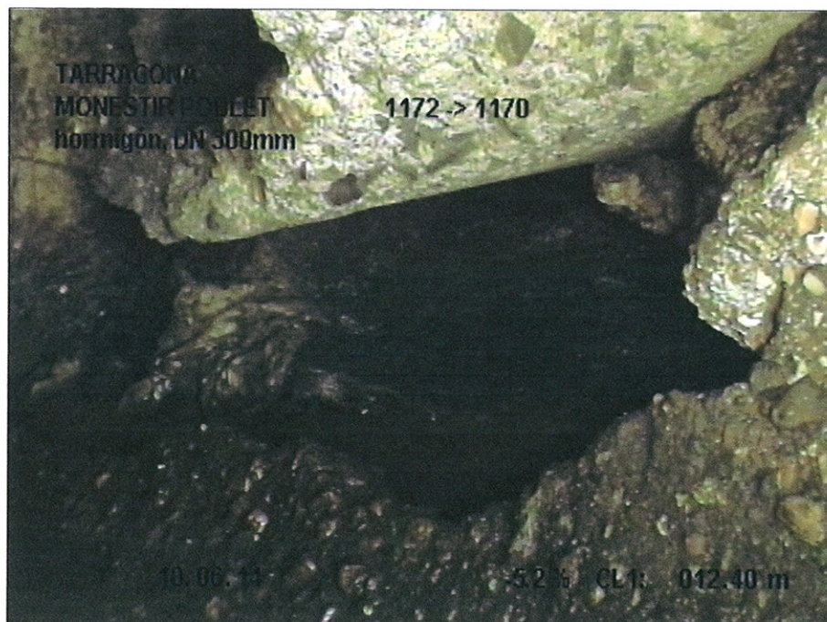
Fotografía: 5_5a, 00:02:00 12,4m, Acometida mal montada a las 03 horas, con filtración de agua
