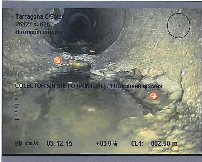
Foto: 5_5A, MPEG #: 021215_1, 00:05:41 2,9m, COLECTOR SIN SUELO (PUNTUAL) , filtraciones graves
