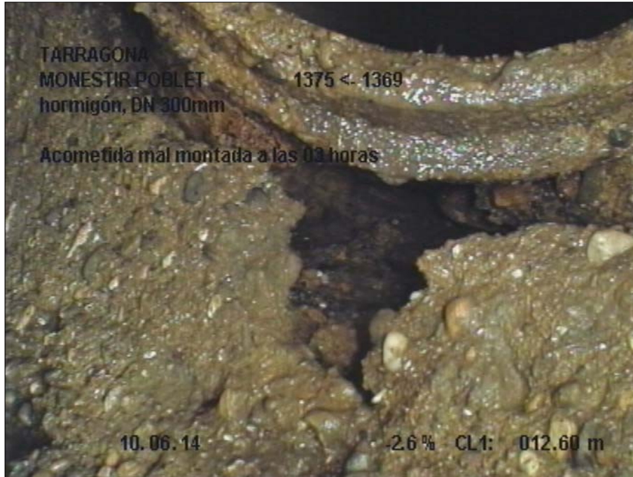
Fotografía: 5_3a, 00:01:34 12,6m, Acometida mal montada a las 03 horas
