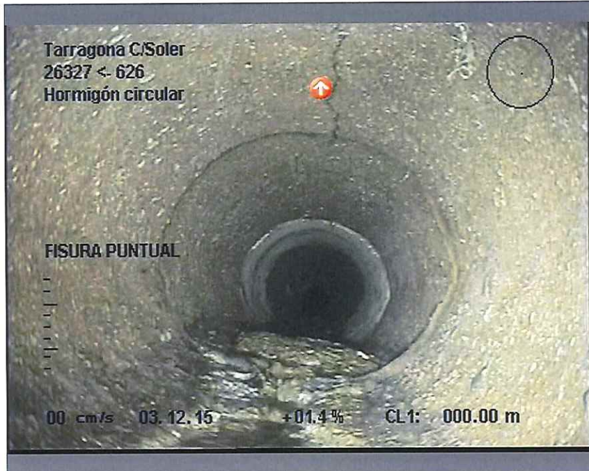
Foto: 5_3A, MPEG #: 021215_1, 00:00:10 1m, FISURA PUNTUAL
