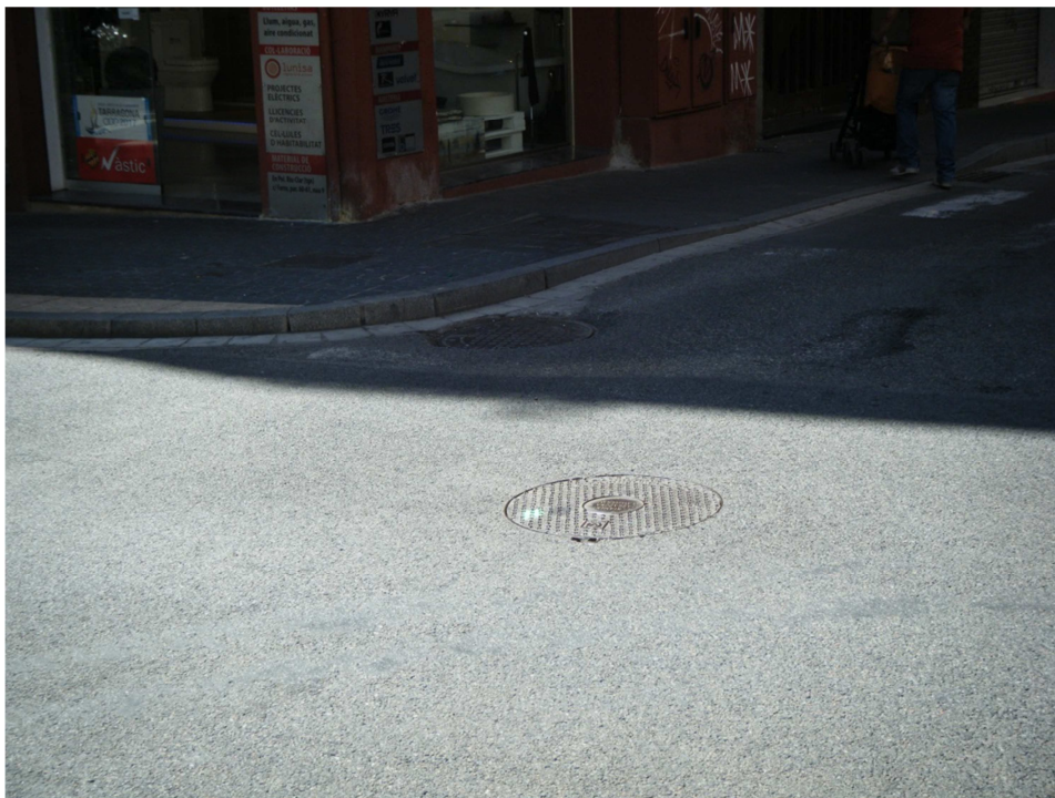
FOTO N°6: Segon pou de registre a renovar per un altre de material plàstic, PVC corrugat, en el carrer de Soler a partir del carrer del Gasòmetre.
