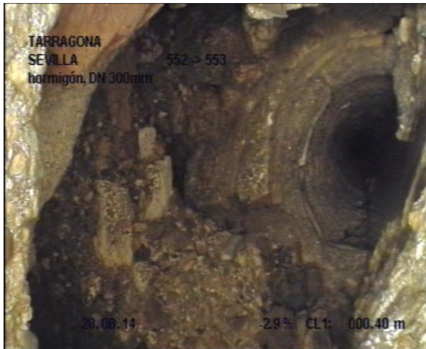
Foto: 7_7_46_B.jpg 0m, PARED Y TECHO DERRUMBADO
