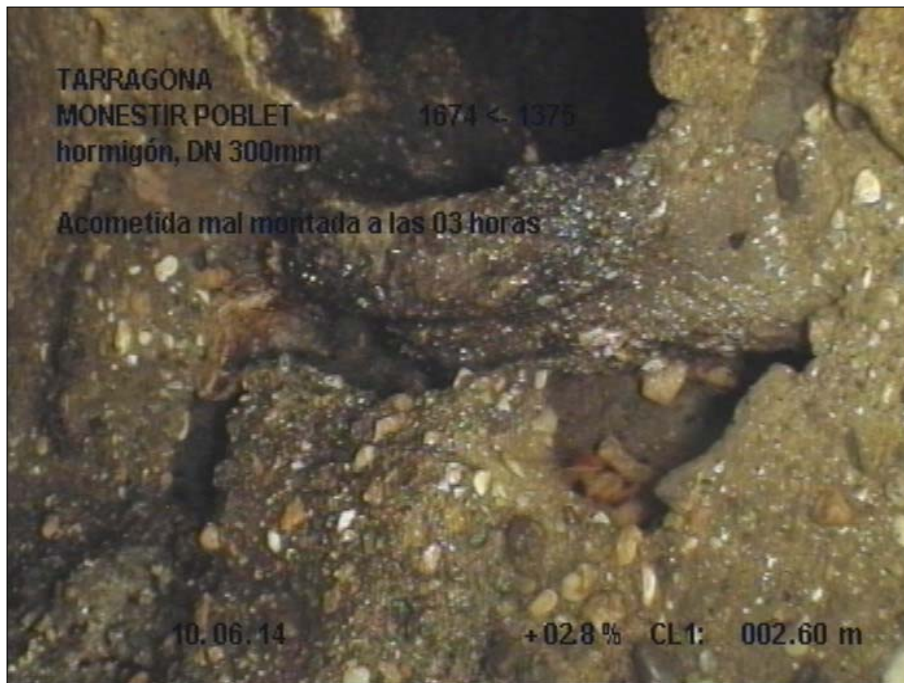
Fotografía: 15_3a, 00:00:29 2,6m, Acometida mal montada a las 03 horas
