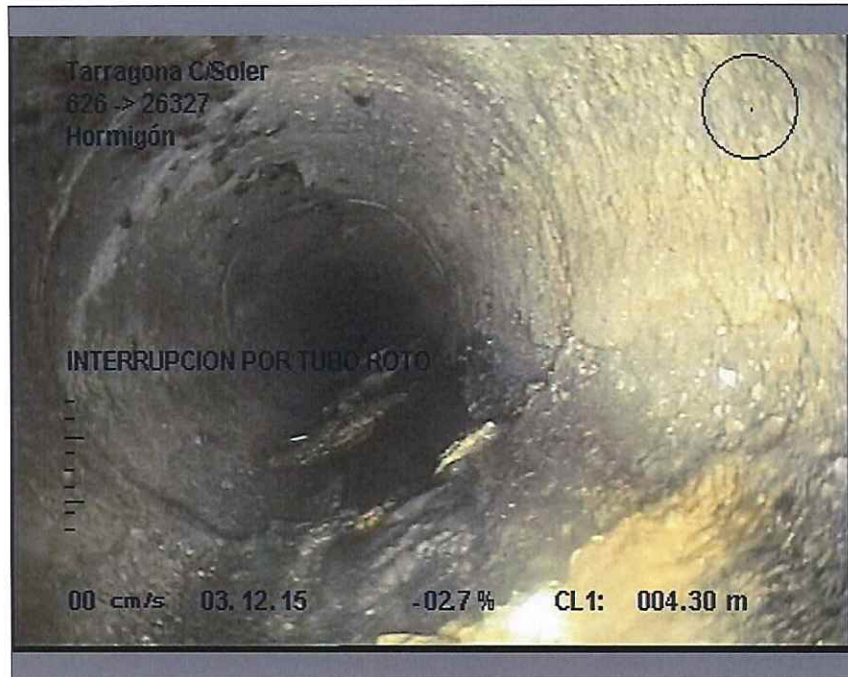
Foto: 8_7A, MPEG #: 021215_1, 00:01:58 4,3m, INTERRUPCION POR TUBO ROTO
