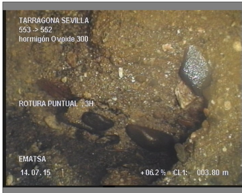
Foto: 5_5_24_A.JPG 3,8m, ROTURA PUNTUAL , 3H
