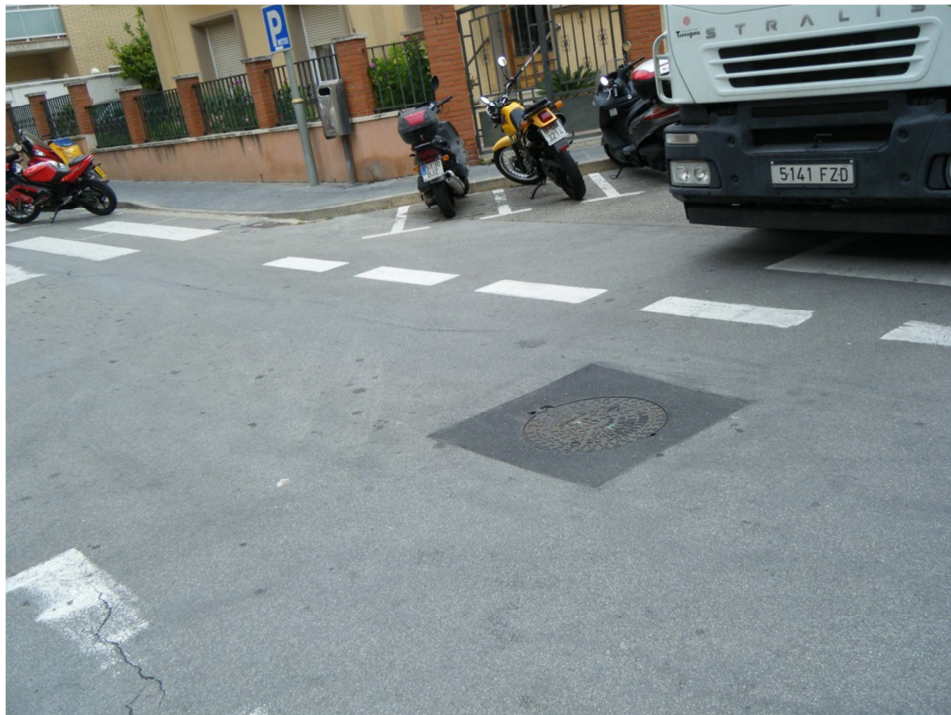
FOTO N°2: Marques vials existents en els vials d'obra que es deuran tornar a pintar.
