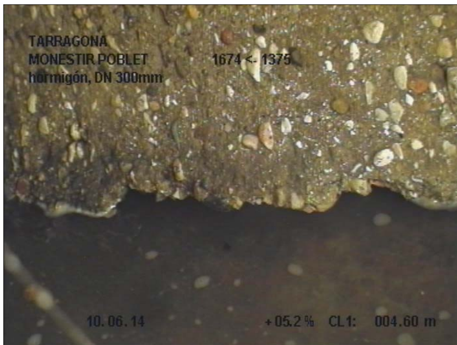
Fotografía: 17_5a, 00:02:22 4,4m, Roturas. Faltan trozos desde 03 hasta 08 horas
