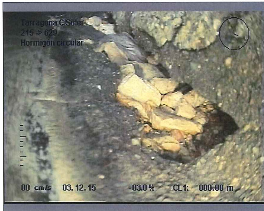
Foto: 4_3B, MPEG #: 021215_1, 00:00:09 1m, ROTURA PUNTUAL CON PERDIDA DE MATERIAL , FILTRACIONES GRAVES
