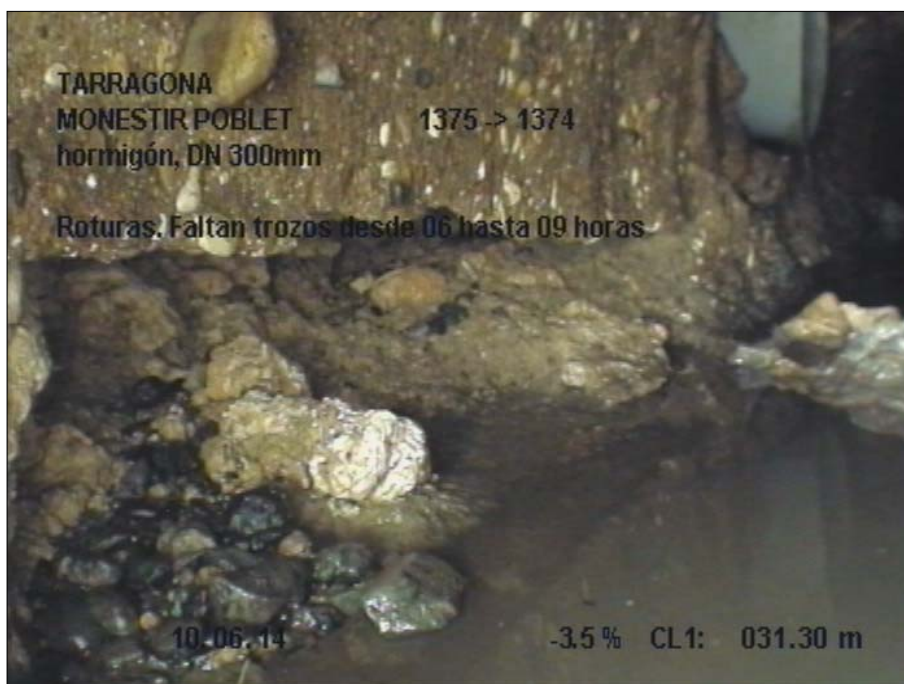
Fotografía: 4_16a, 00:05:34 31,3m, Roturas. Faltan trozos desde 06 hasta 09 horas
