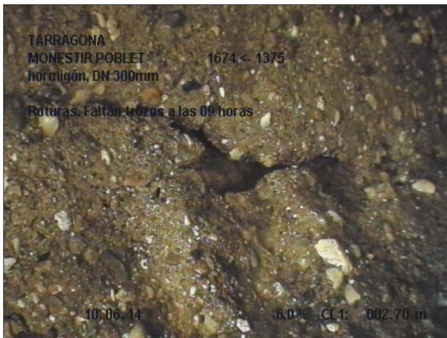
Fotografía: 16_4a, 00:01:20 2,7m, Roturas. Faltan trozos a las 09 horas
