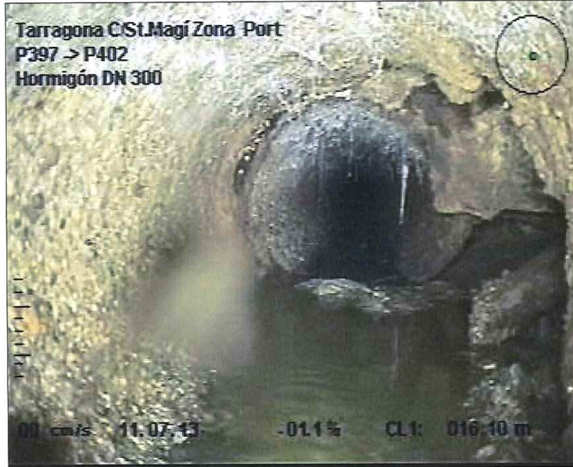
Foto: 7_7A, MPEG #: 110713_1, 00:01:38 16,5m, PARED Y TECHO DERRUMBADO , con filtraciones GRAVES
