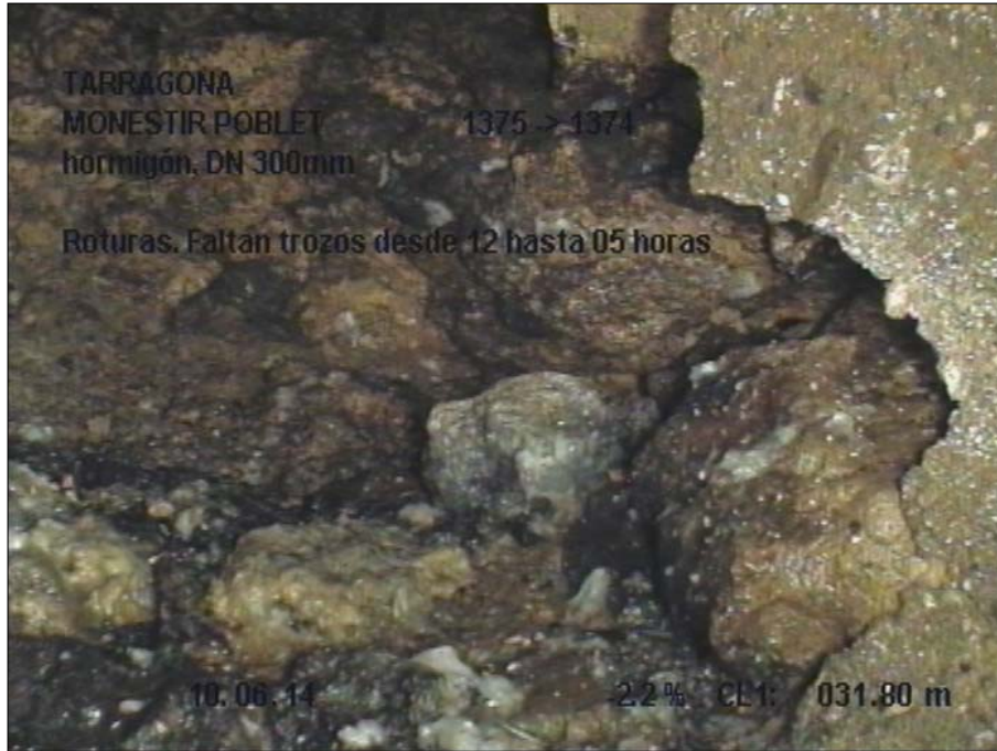
Fotografía: 4_17a, 00:06:31 31,8m, Roturas. Faltan trozos desde 12 hasta 05 horas
