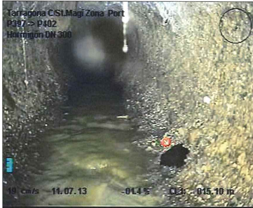
Foto: 7_5A, MPEG #: 110713_1, 00:01:19 15,1m, ROTURA PUNTUAL , con filtraciones
