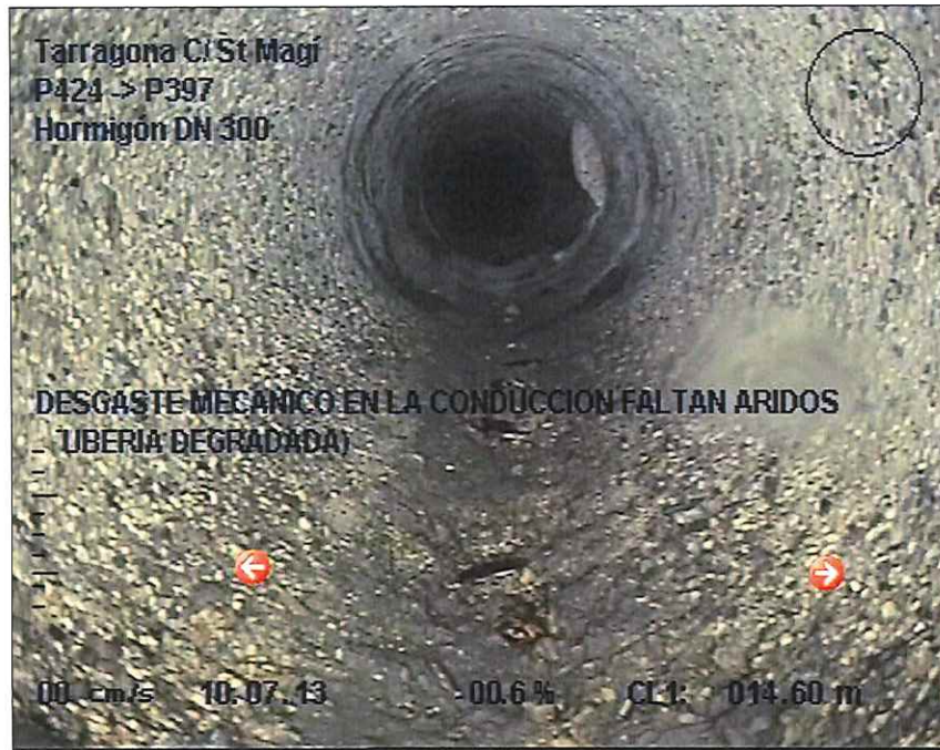
Foto: 6_4A, MPEG #: 110713_1, 00:01:26 14,6m, DESGASTE MECANICO EN LA CONDUCCION FALTAN ARIDOS (TUBERIA DEGRADADA)
