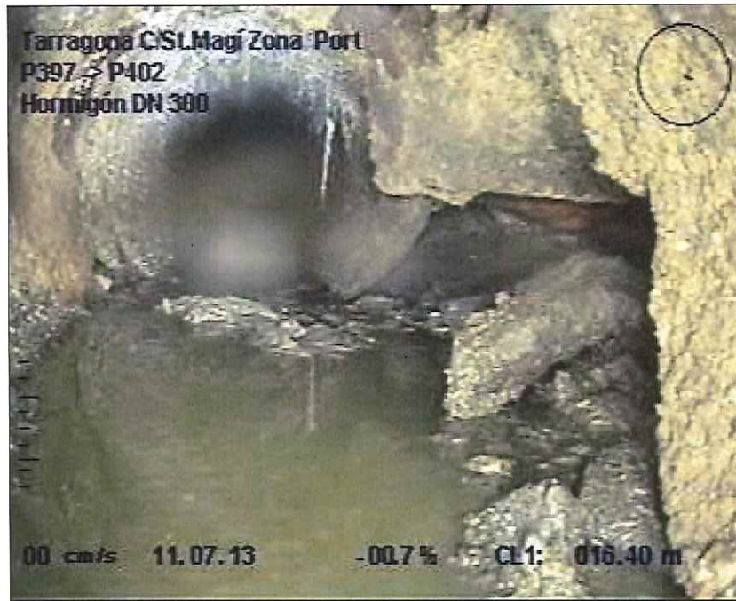
Foto: 7_8A, MPEG #: 110713_1 17m, INTERRUPCION POR TUBO HUNDIDO G-P402
