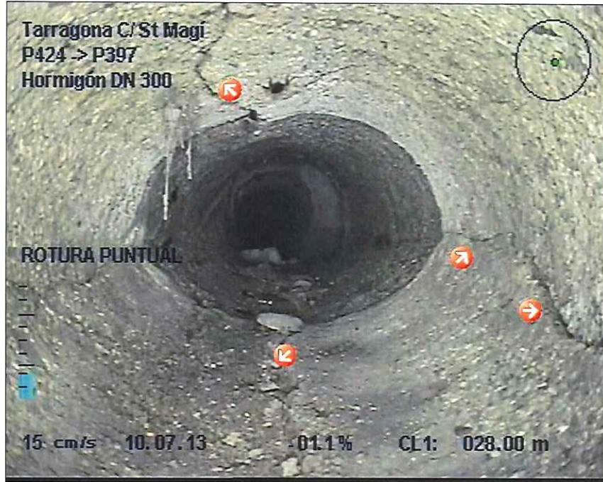
Foto: 6_8A, MPEG #: 110713_1, 00:02:58 27,8m, ROTURA PUNTUAL
