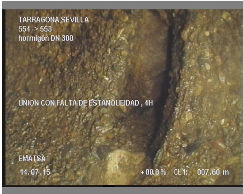
Foto: 6_6_31_A.JPG 7,6m, UNION CON FALTA DE ESTANQUEIDAD , 4H
