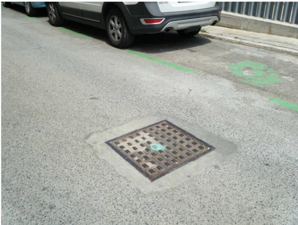
FOTO Nº2: Tapa de registre del pou de inici de la renovació del col·lector, ubicat en el centre del carrer Sant Magí.
