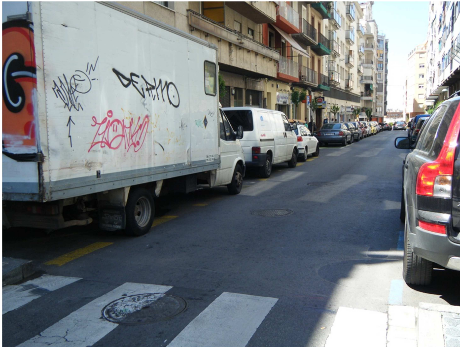
FOTO Nº1: Vista dels tres pous de registre existents en el tram d'inici de la renovació del col·lector de diàmetre 300 mm, en el carrer Sevilla des de la plaça Ponent, dels quals només es deixarà en ús un.
