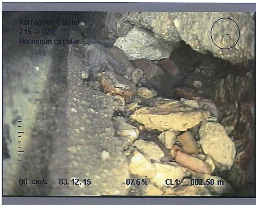
Foto: 4_4B, MPEG #: 021215_1, 00:01:07 2,2m, PARED Y TECHO DERRUMBADO , GRAVES FILTRACIONES
