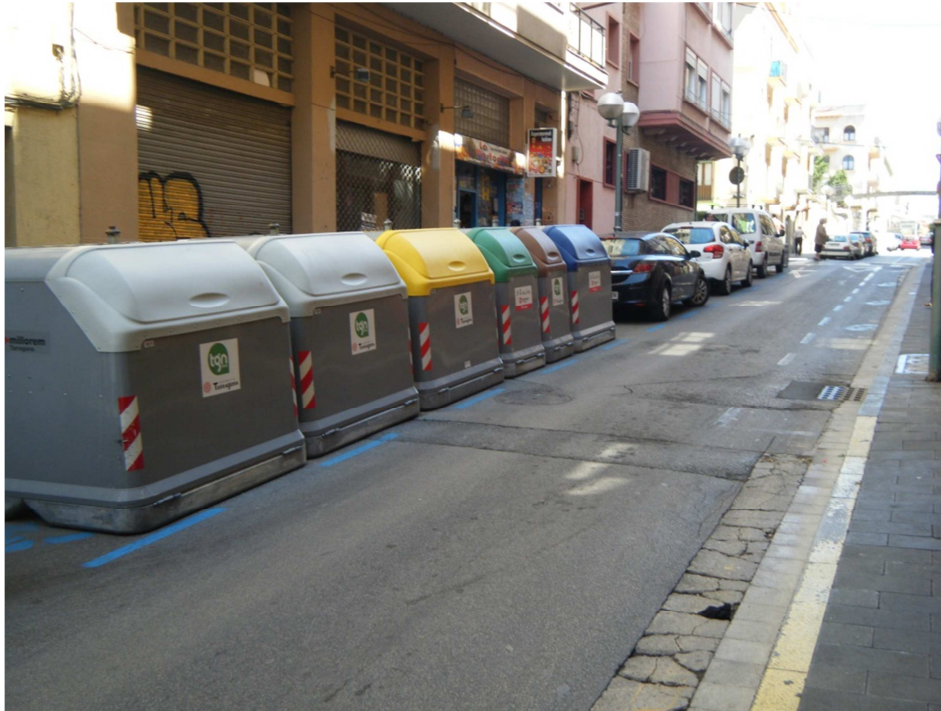
FOTO N°3: Vista del estat del paviment en alguns trams de la calçada del carrer de Soler.
