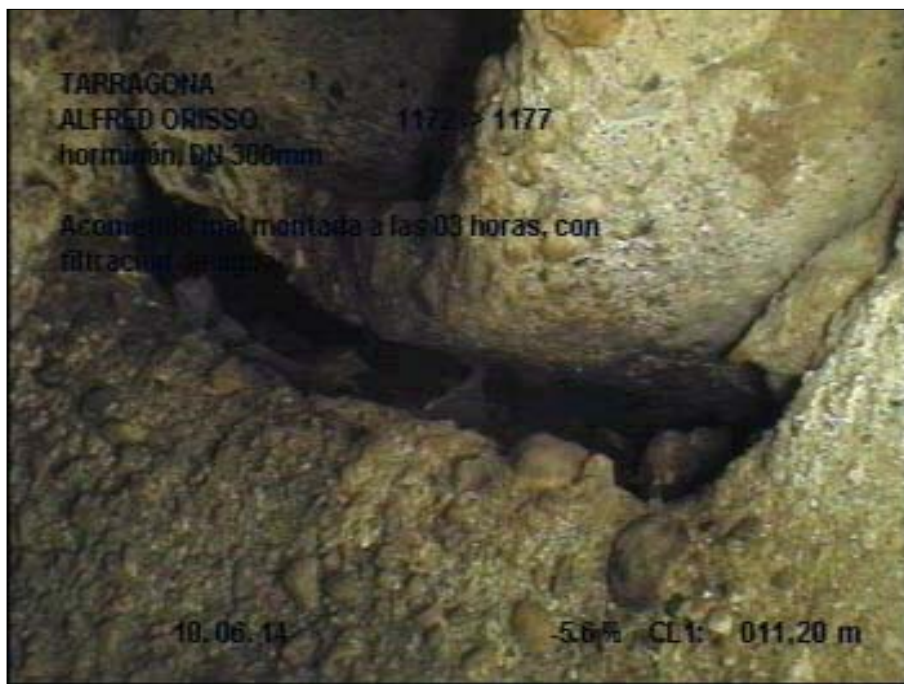
Fotografía: 4_4a, 00:03:35 11,2m, Acometida mal montada a las 03 horas, con filtración de agua
