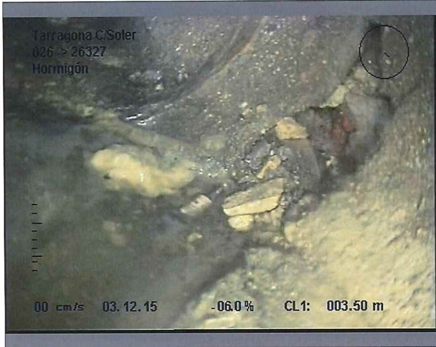
Foto: 8_6B, MPEG #: 021215_1, 00:01:27 3,5m, ROTURA PUNTUAL , con filtraciones graves
