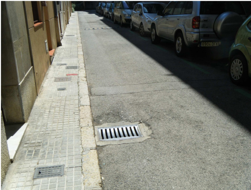
FOTO N°3: Vista d'alguns dels serveis existents en vorera com; aigua potable, incendis, electricitat, entre uns altres.
