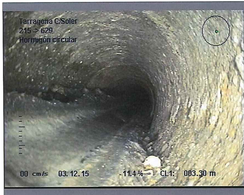
Foto: 4_6A, MPEG #: 021215_1, 00:01:49 2,9m, INTERRUPCION POR TUBO HUNDIDO
