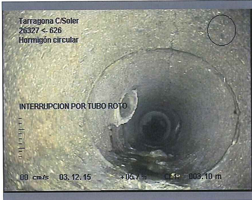
Foto: 6_6A, MPEG #: 021215_1, 00:06:48 3,1m, INTERRUPCION POR TUBO ROTO
