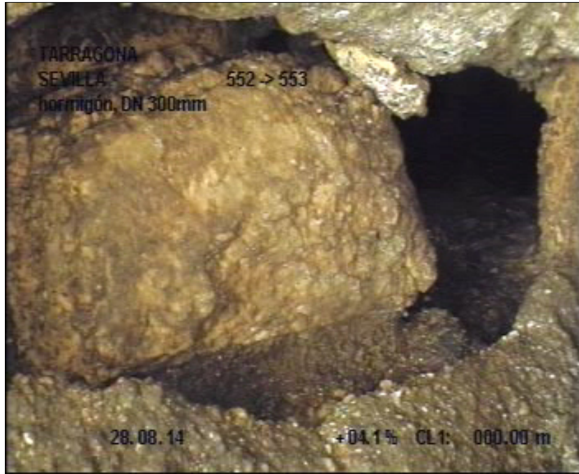
Foto: 7_7_46_A.jpg 0m, PARED Y TECHO DERRUMBADO
