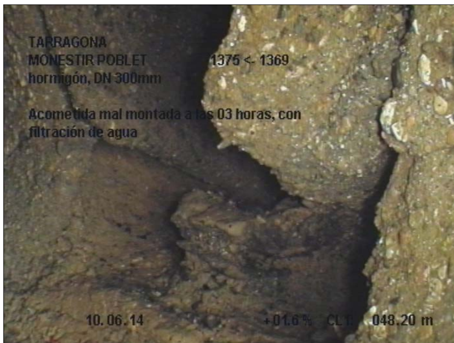
Fotografía: 5_14a, 00:08:11 48,2m, Acometida mal montada a las 03 horas, con filtración de agua
