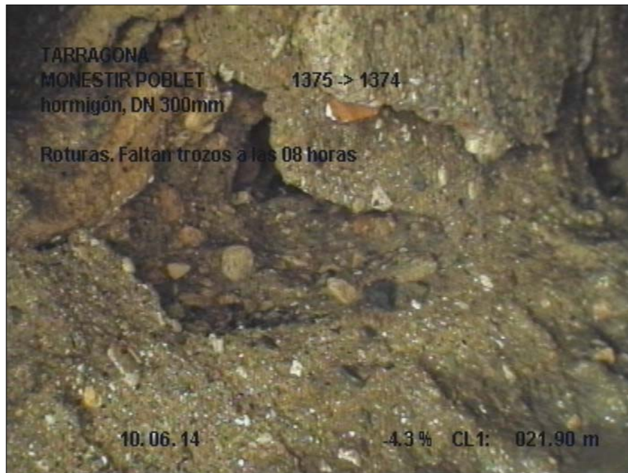
Fotografía: 4_8a, 00:03:04 21,9m, Roturas. Faltan trozos a las 08 horas
