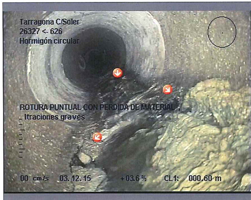
Foto: 5_4A, MPEG #: 021215_1, 00:03:09 1m, ROTURA PUNTUAL CON PERDIDA DE MATERIAL , filtraciones graves
