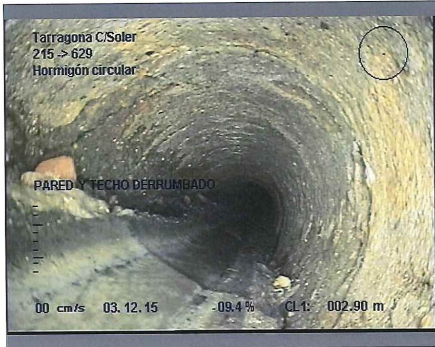
Foto: 4_5A, MPEG #: 021215_1, 00:01:43 2,9m, PARED Y TECHO DERRUMBADO
