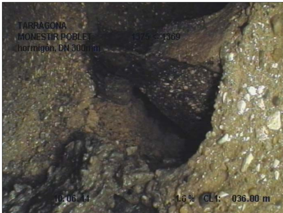
Fotografía: 5_9b, 00:05:21 36m, Acometida mal montada a las 02 horas
