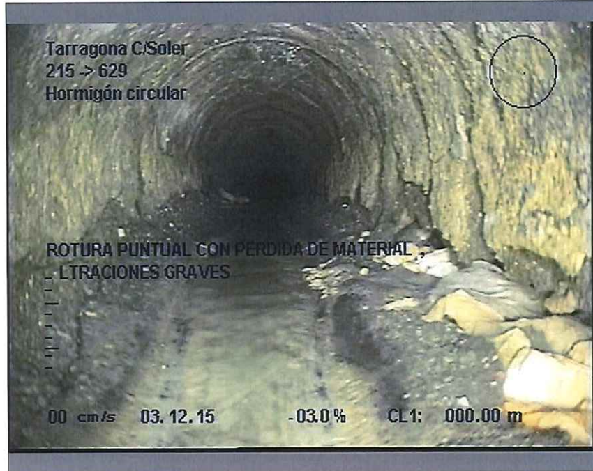
Foto: 4_3A, MPEG #: 021215_1, 00:00:09 1m, ROTURA PUNTUAL CON PERDIDA DE MATERIAL , FILTRACIONES GRAVES
