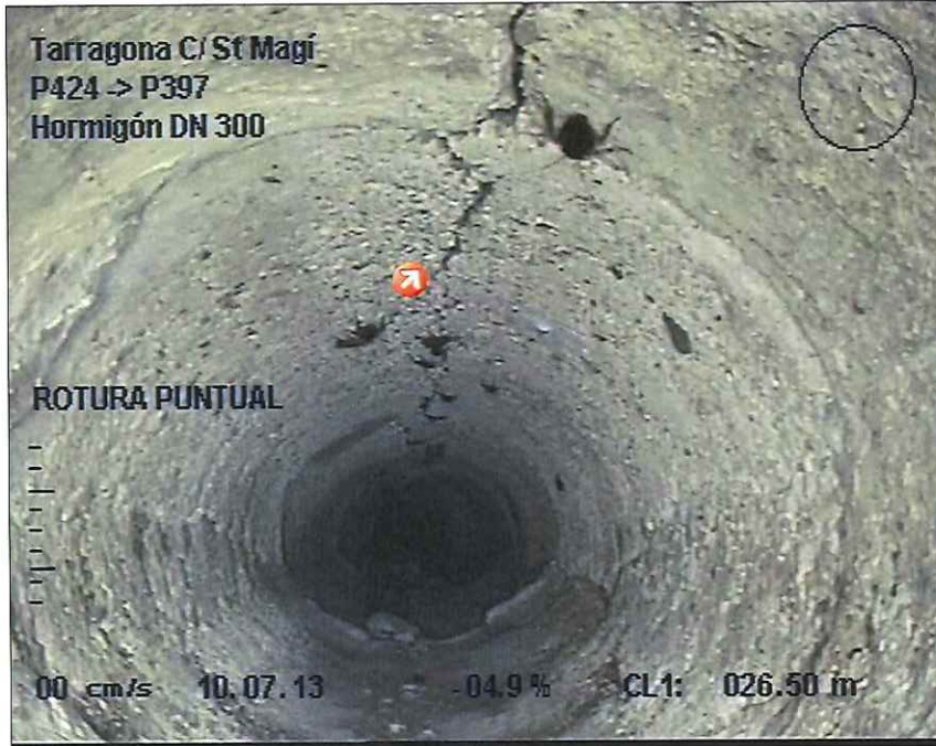
Foto: 6_7A, MPEG #: 110713_1, 00:02:36 26,5m, ROTURA PUNTUAL
