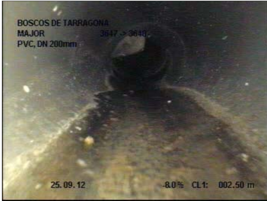
Fotografía: 2_2a, Nº Video: 1, 00:00:37 3,7m, Acometida sobresaliente a las 09 horas, (sobresale 50 cm)
