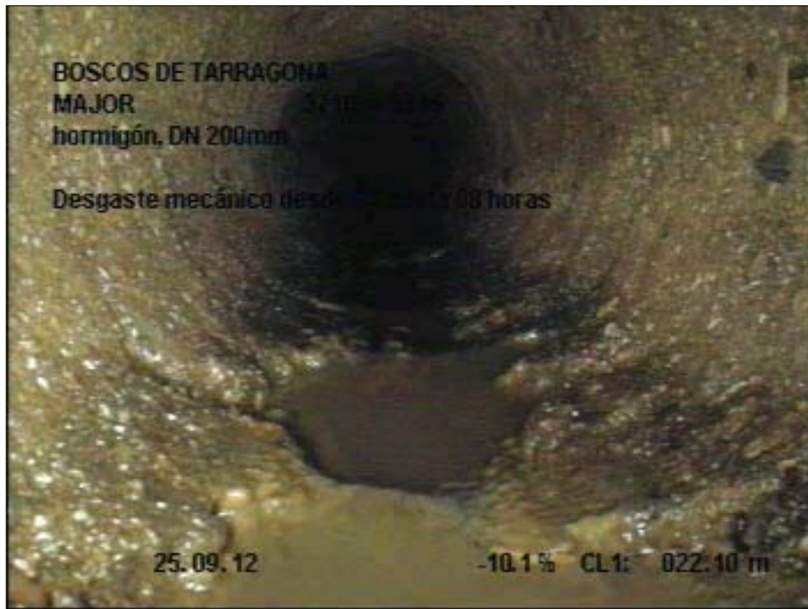
Fotografía: 63_13a, Nº Video: 1, 00:05:11 22,1m, Roturas. Faltan trozos desde 05 hasta 07 horas, con filtración de agua
