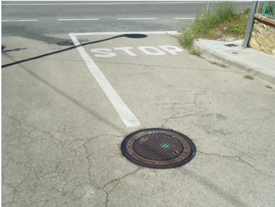
FOTO N°6: Últim tram de col·lector i pous de registre a substituir.
