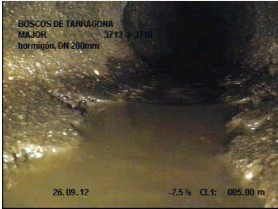
Fotografía: 104_3a, Nº Video: 1, 00:01:12 5m, Roturas. Faltan trozos desde 04 hasta 08 horas, con humedad visible
