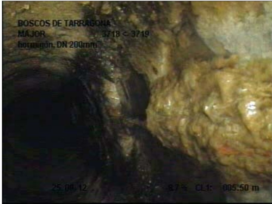
Fotografía: 48_6a, Nº Video: 1, 00:01:33 6m, Roturas. Faltan trozos desde 04 hasta 08 horas, con filtración de agua
