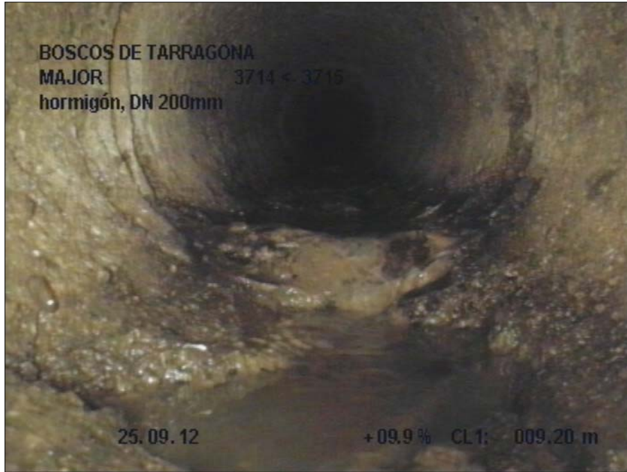
Fotografía: 89_5a, Nº Video: 1, 00:02:01 8,4m, Roturas. Faltan trozos desde 04 hasta 08 horas, con humedad visible
