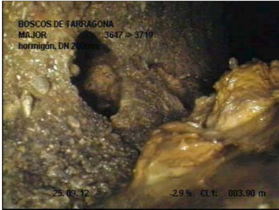
Fotografía: 9_4a, Nº Video: 1, 00:00:46 4m, Roturas. Faltan trozos desde 08 hasta 11 horas
