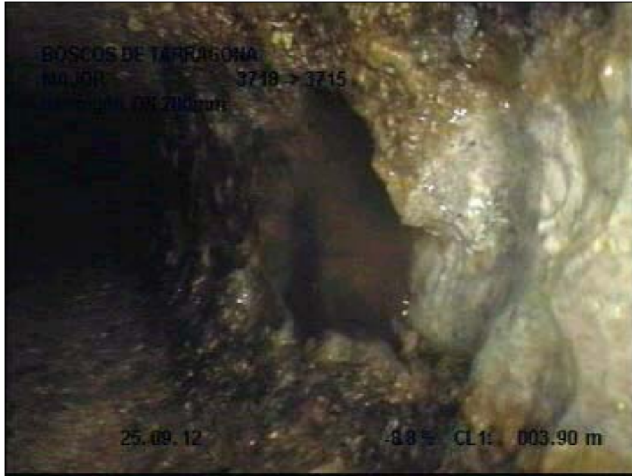
Fotografía: 54_3a, Nº Video: 1, 00:00:33 4m, Roturas. Faltan trozos desde 05 hasta 07 horas, con filtración de agua
