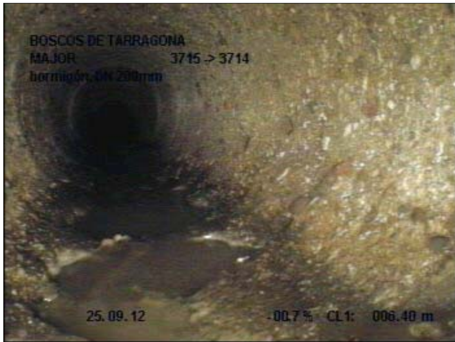
Fotografía: 81_6a, Nº Video: 1, 00:01:52 6,4m, Roturas. Faltan trozos desde 04 hasta 08 horas, con humedad visible
