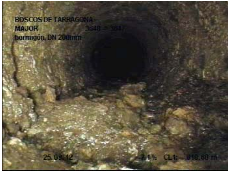
Fotografía: 20_8a, Nº Video: 1, 00:02:07 10,7m, Roturas. Faltan trozos desde 12 hasta 12 horas
