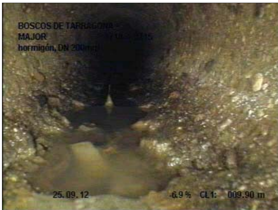
Fotografía: 57_6a, Nº Video: 1, 00:02:02 10m, Roturas. Faltan trozos desde 05 hasta 07 horas, con filtración de agua
