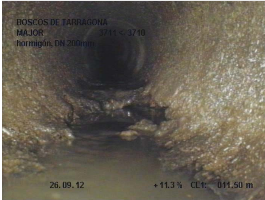
Fotografía: 124_7a, Nº Video: 1, 00:02:00 11,5m, Roturas. Faltan trozos desde 04 hasta 08 horas, con humedad visible
