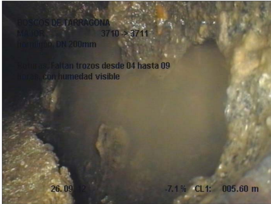
Fotografía: 114_4a, Nº Video: 1, 00:00:57 5,6m, Roturas. Faltan trozos desde 04 hasta 09 horas, con humedad visible
