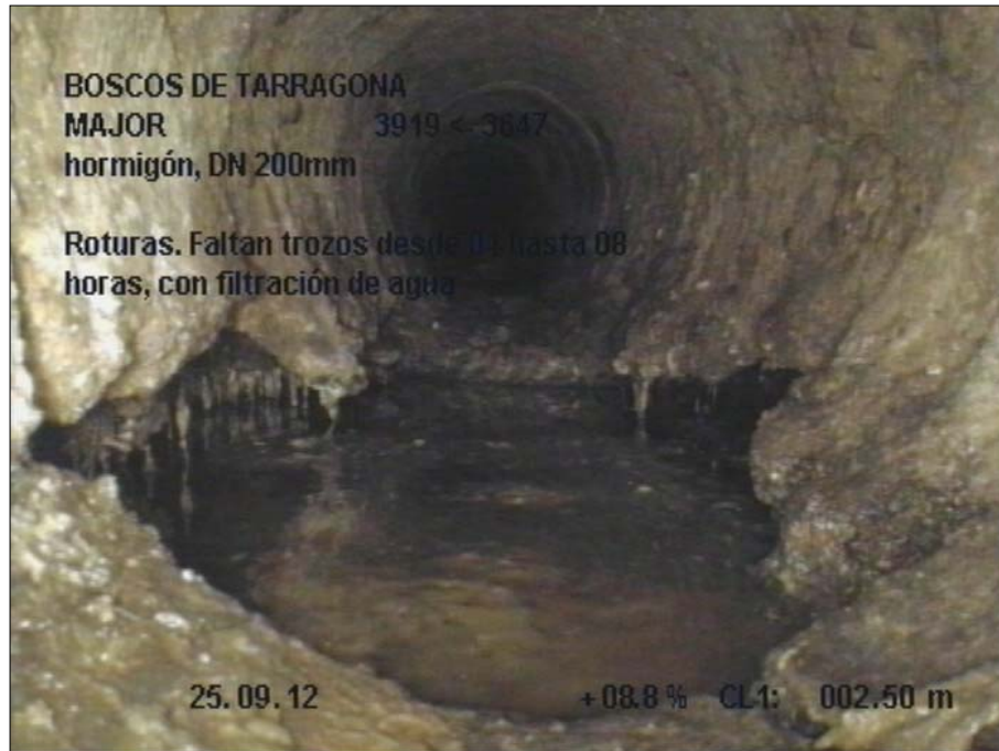
Fotografía: 4_2a, Nº Video: 1, 00:00:37 2,5m, Roturas. Faltan trozos desde 04 hasta 08 horas, con filtración de agua
