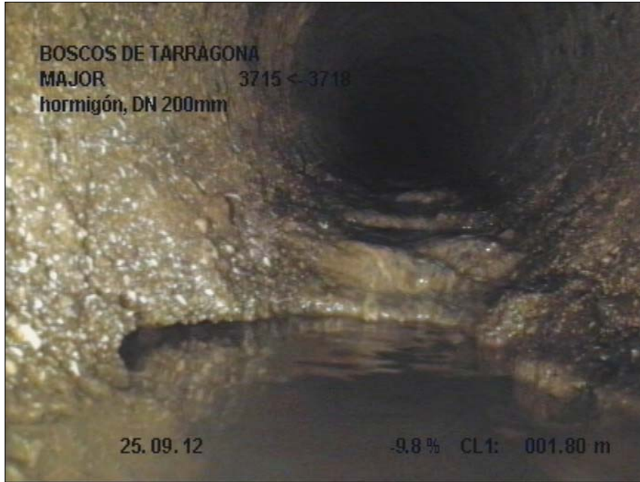
Fotografía: 70_3a, Nº Video: 1, 00:00:20 1,8m, Roturas. Faltan trozos desde 04 hasta 08 horas, con filtración de agua
