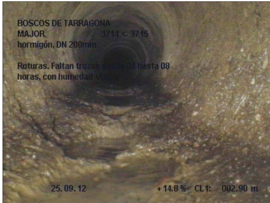
Fotografía: 87_3a, Nº Video: 1, 00:00:38 2,9m, Roturas. Faltan trozos desde 04 hasta 08 horas, con humedad visible
