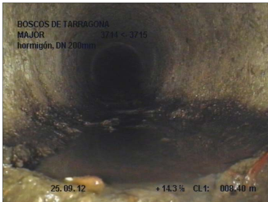
Fotografía: 88_4a, Nº Video: 1, 00:01:21 6m, Roturas. Faltan trozos desde 04 hasta 08 horas, con humedad visible
