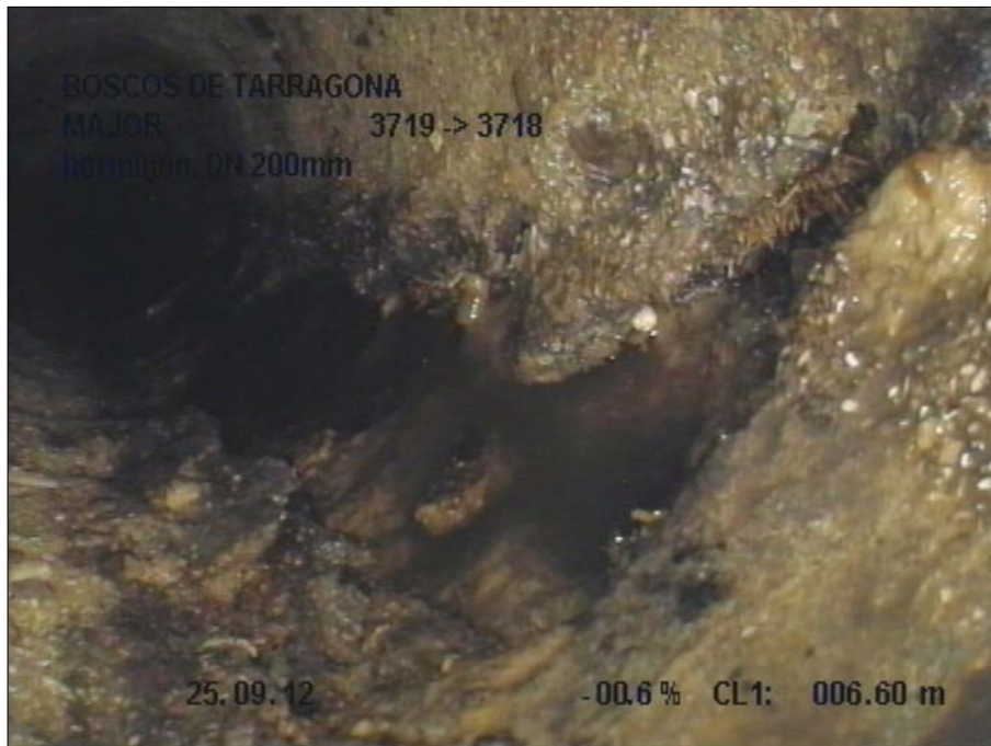
Fotografía: 39_6a, Nº Video: 1, 00:02:19 6,9m, Roturas. Faltan trozos desde 04 hasta 08 horas, con el fondo visible
