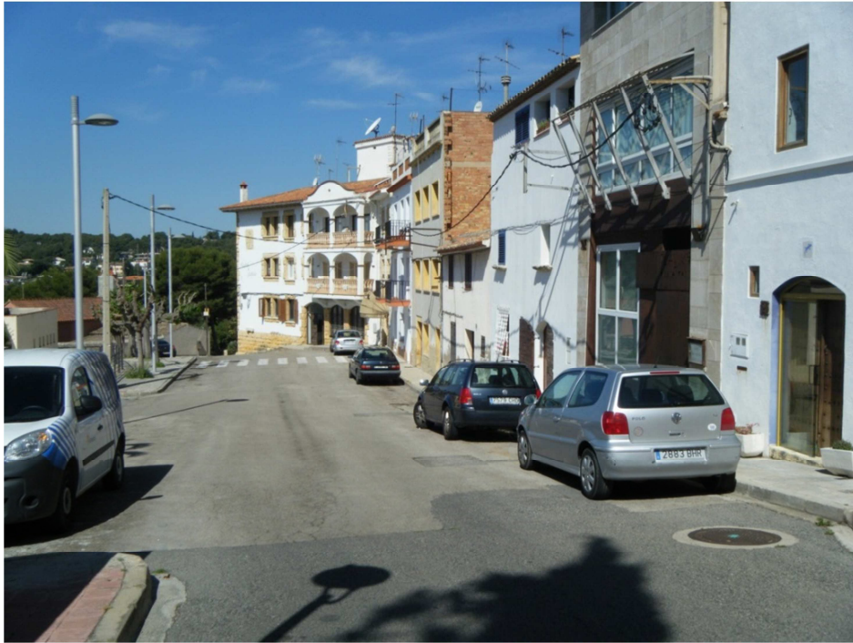
FOTO Nº1: Pou de registre on està previst el començament de la renovació del col·lector de formigó de 200 mm de diàmetre, en el carrer Major, per un altre de PVC doble capa de 400 mm de diàmetre.
