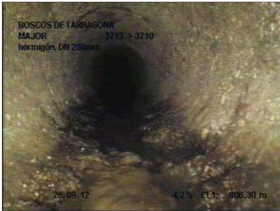
Fotografía: 105_4a, Nº Video: 1, 00:01:41 6,5m, Roturas. Faltan trozos desde 04 hasta 08 horas, con humedad visible
