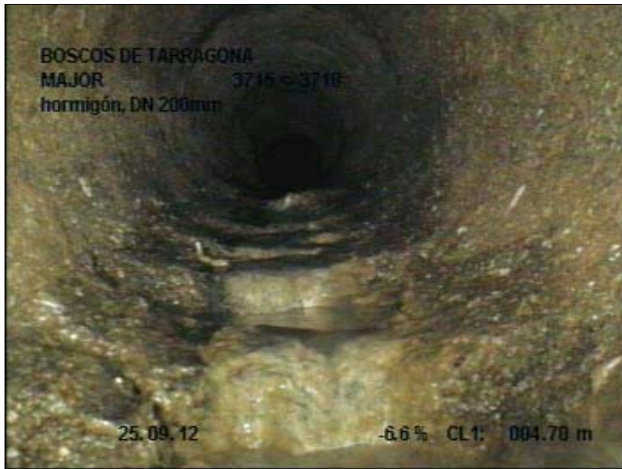
Fotografía: 72_5a, Nº Video: 1, 00:01:28 4,7m, Roturas. Faltan trozos desde 05 hasta 07 horas, con humedad visible
