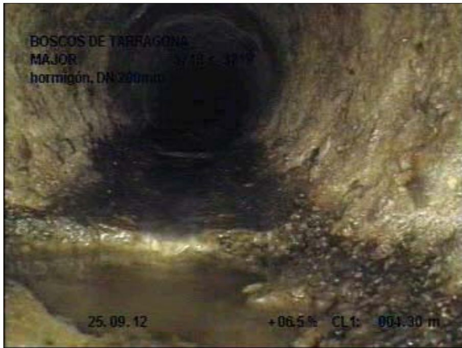
Fotografía: 46_4a, Nº Video: 1, 00:00:54 4,3m, Roturas. Faltan trozos desde 04 hasta 08 horas, con filtración de agua
