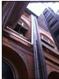
Foto exemple detall montant provisional alimentació telecomunicacions VDI (veu, dades, internet) desde PB fins Arxiu / Alcaldia
