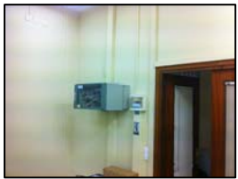
Foto detalle del Rack a desplazar
