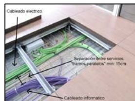
Foto exemple distribució cablejat informàtic per terra (canal safata 300x600)
