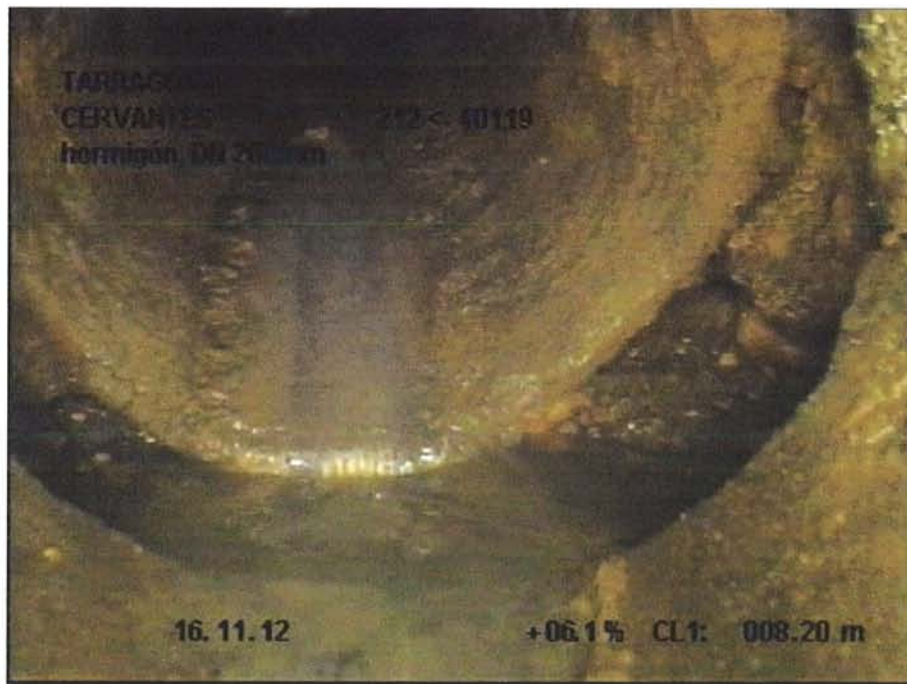
Fotografía: 57_5a, Nº Video: 1, 00:01:52 8,4m, Junta abierta desde 12 hasta 12 horas, con filtración de agua
