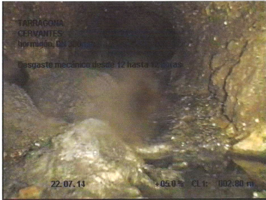
Fotografía: 19_3a, Nº Video: 1, 00:00:51 2,9m, Roturas. Faltan trozos desde 12 hasta 12 horas
