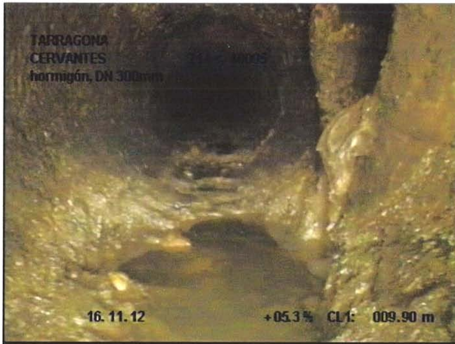
Fotografía: 28_2a, N° Video: 1, 00:01:09 10,1m, Roturas. Faltan trozos desde 05 hasta 07 horas, con filtración de agua
