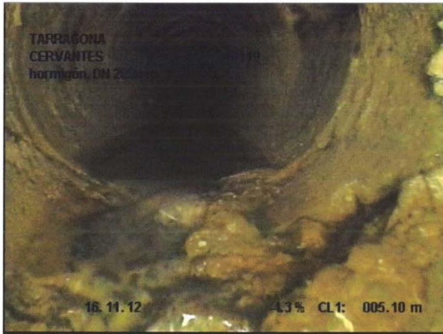
Fotografía: 55_3a, Nº Video: 1, 00:01:05 5,2m, Roturas. Faltan trozos desde 12 hasta 12 horas
