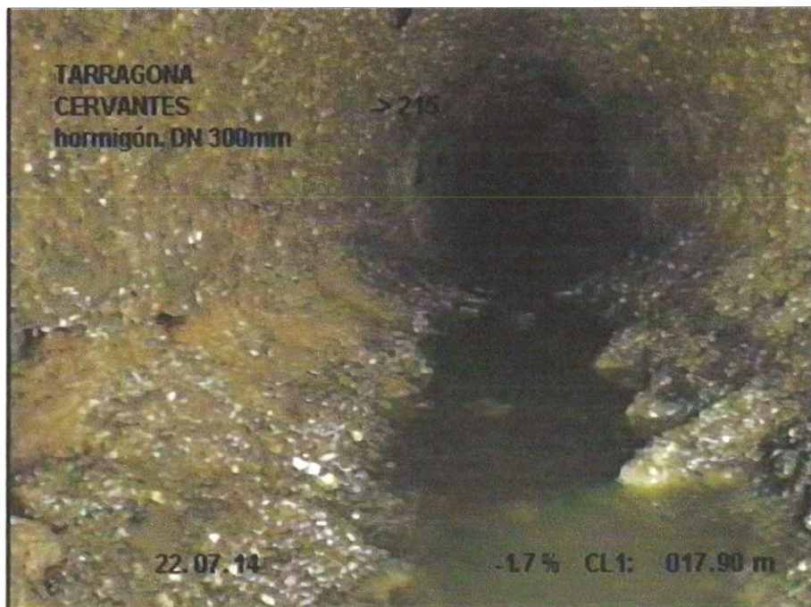
Fotografía: 1_12a, Nº Video: 1, 00:06:30 17,9m, Roturas. Faltan trozos desde 03 hasta 09 horas
