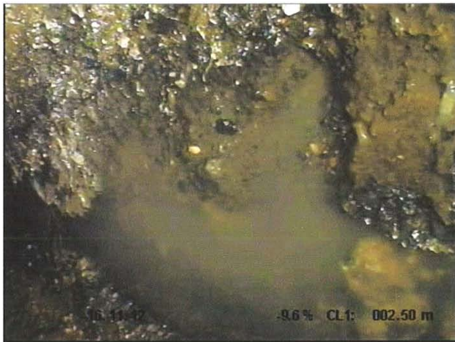
Fotografía: 23_5a, N° Video: 1, 00:00:30 2,5m, Roturas. Faltan trozos desde 05 hasta 07 horas, con filtración de agua
