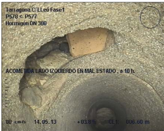
Foto: 12_9A, MPEG #: 140513_1, 00:01:42 6,6m, ACOMETIDA LADO IZQUIERDO EN MAL ESTADO , a 10 h.
