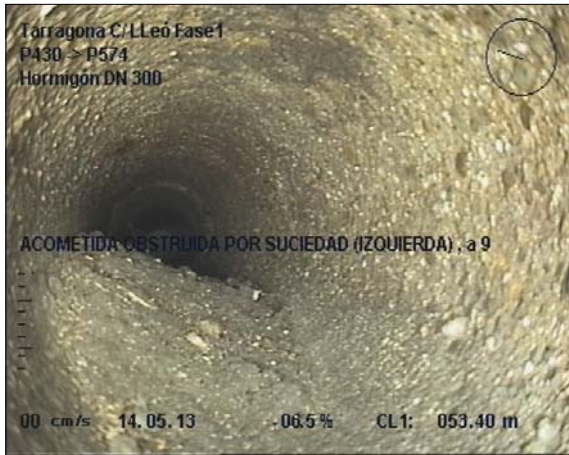
Foto: 1_12B, MPEG #: 140513_1, 00:06:05 53,4m, ACOMETIDA OBSTRUIDA POR SUCIEDAD (IZQUIERDA) , a 9 h.
