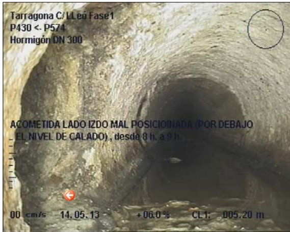
Foto: 6_7A, MPEG #: 140513_1, 00:02:58 5,2m, ACOMETIDA LADO IZDO MAL POSICIONADA (POR DEBAJO DEL NIVEL DE CALADO) , desde 8 h. a 9 h.
