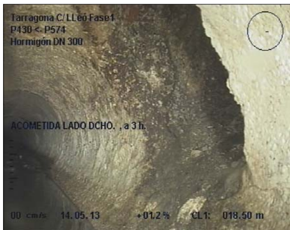
Foto: 6_13A, MPEG #: 140513_1, 00:06:28 18,5m, ACOMETIDA LADO DCHO. , a 3 h.
