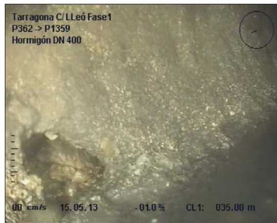
Foto: 21_14B, MPEG #: 140513_1, 00:04:50 34,8m, ROTURA PUNTUAL , con filtraciones
