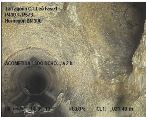
Foto: 2_5A, MPEG #: 140513_1, 00:01:32 21,4m, ACOMETIDA LADO DCHO. , a 2 h.
