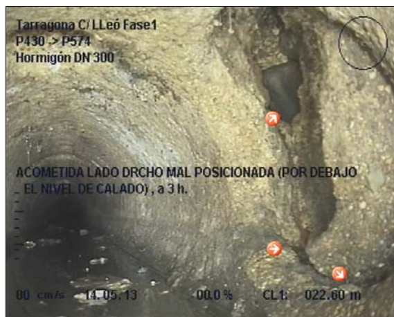
Foto: 1_5A, MPEG #: 140513_1, 00:01:17 23m, ACOMETIDA LADO DRCHO MAL POSICIONADA (POR DEBAJO DEL NIVEL DE CALADO) , a 3 h.
