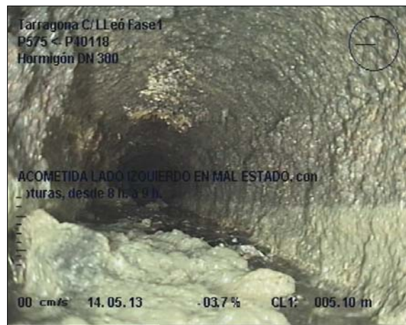
Foto: 9_4A, MPEG #: 140513_1, 00:01:38 5,1m, ACOMETIDA LADO IZQUIERDO EN MAL ESTADO, con roturas, desde 8 h. a 9 h.
