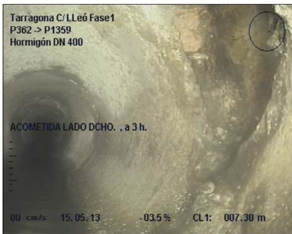
Foto: 21_3A, MPEG #: 140513_1, 00:00:37 7,3m, ACOMETIDA LADO DCHO. , a 3 h.
