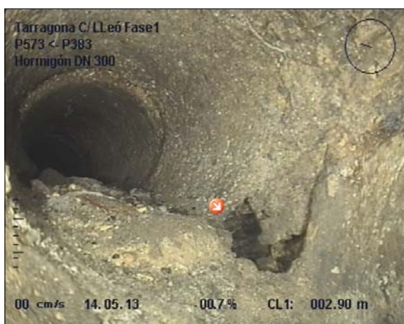
Foto: 3_4B, MPEG #: 140513_1, 00:00:30 2,9m, ACOMETIDA LADO DERECHO EN MAL ESTADO, roturas, a 9 h.
