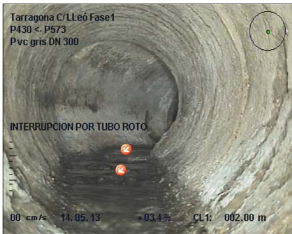
Foto: 5_5A, MPEG #: 140513_1, 00:01:33 2m, INTERRUPCION POR TUBO ROTO G-P573
