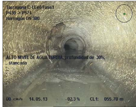
Foto: 1_13A, MPEG #: 140513_1, 00:06:49 55,7m, ALTO NIVEL DE AGUA TURBIA, profundidad de 30%, estancada
