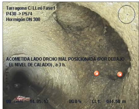
Foto: 1_9A, MPEG #: 140513_1, 00:04:29 44,8m, ACOMETIDA LADO DRCHO MAL POSICIONADA (POR DEBAJO DEL NIVEL DE CALADO) , a 3 h.
