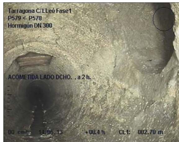
Foto: 11_4A, MPEG #: 140513_1, 00:00:36 2,7m, ACOMETIDA LADO DCHO. , a 2 h.
