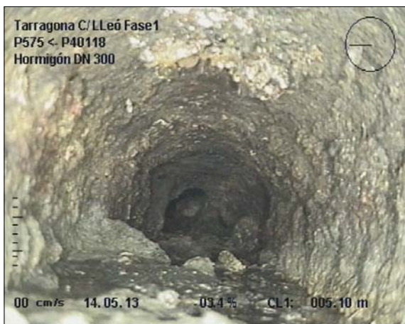
Foto: 9_4B, MPEG #: 140513_1, 00:01:38 5,1m, ACOMETIDA LADO IZQUIERDO EN MAL ESTADO, con roturas, desde 8 h. a 9 h.
