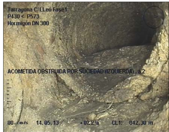
Foto: 2_8A, MPEG #: 140513_1, 00:03:41 42,3m, ACOMETIDA OBSTRUIDA POR SUCIEDAD (IZQUIERDA) , a 2 h.
