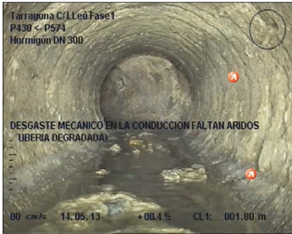
Foto: 6_3A, MPEG #: 140513_1, 00:00:11 1,8m, DESGASTE MECANICO EN LA CONDUCCION FALTAN ARIDOS (TUBERIA DEGRADADA)
