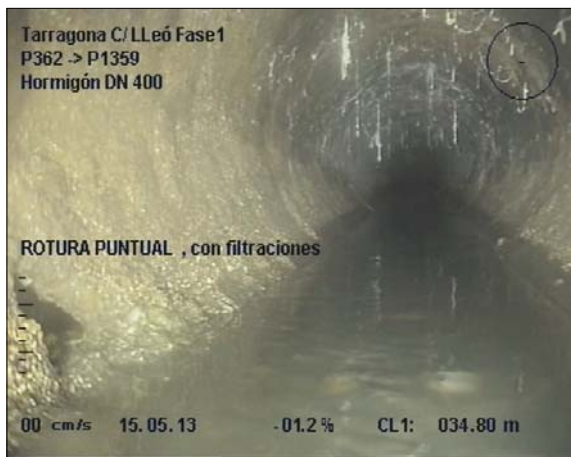
Foto: 21_14A, MPEG #: 140513_1, 00:04:50 34,8m, ROTURA PUNTUAL , con filtraciones
