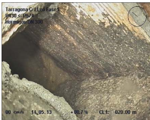
Foto: 6_14B, MPEG #: 140513_1, 00:06:46 20m, ACOMETIDA OBSTRUIDA POR SUCIEDAD (IZQUIERDA) , a 10 h.
