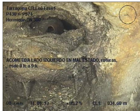
Foto: 6_19A, MPEG #: 140513_1, 00:09:22 34,6m, ACOMETIDA LADO IZQUIERDO EN MAL ESTADO, roturas, desde 8 h. a 9 h.
