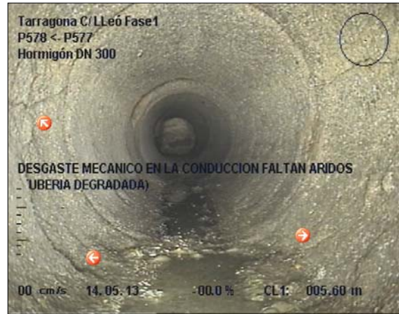
Foto: 11_8A, MPEG #: 140513_1, 00:01:22 5,6m, DESGASTE MECANICO EN LA CONDUCCION FALTAN ARIDOS (TUBERIA DEGRADADA)
