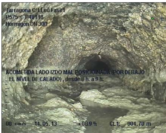
Foto: 9_3A, MPEG #: 140513_1, 00:01:17 5,1m, ACOMETIDA LADO IZDO MAL POSICIONADA (POR DEBAJO DEL NIVEL DE CALADO) , desde 8 h. a 9 h.
