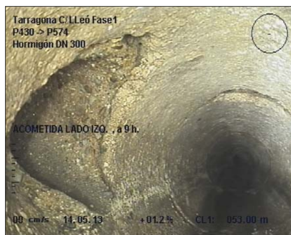
Foto: 1_12A, MPEG #: 140513_1, 00:06:05 53,4m, ACOMETIDA OBSTRUIDA POR SUCIEDAD (IZQUIERDA) , a 9 h.
