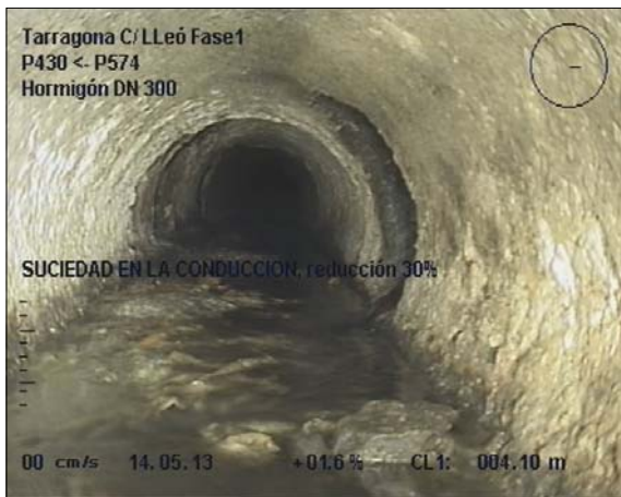
Foto: 6_5A, MPEG #: 140513_1, 00:01:36 4,1m, SUCIEDAD EN LA CONDUCCION, reducción 30%
