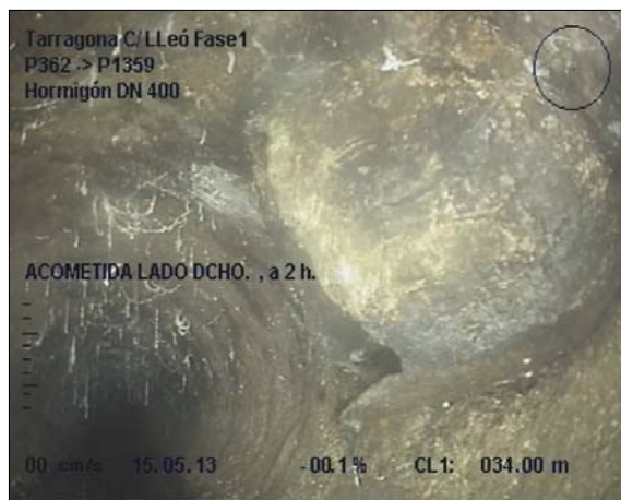
Foto: 21_13A, MPEG #: 140513_1, 00:04:33 34m, ACOMETIDA LADO DCHO. , a 2 h.
