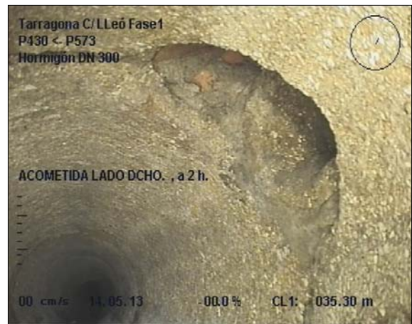
Foto: 2_6A, MPEG #: 140513_1, 00:02:48 35,3m, ACOMETIDA LADO DCHO. , a 2 h.
