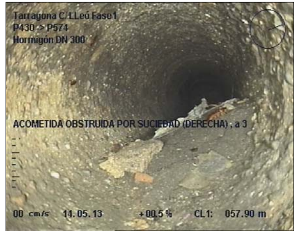
Foto: 1_16B, MPEG #: 140513_1, 00:07:46 57,9m, ACOMETIDA OBSTRUIDA POR SUCIEDAD (DERECHA) , a 3 h.
