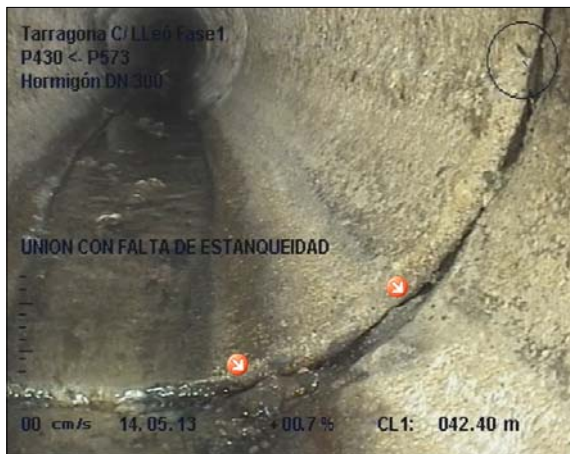
Foto: 2_9A, MPEG #: 140513_1, 00:03:59 42,4m, UNION CON FALTA DE ESTANQUEIDAD
