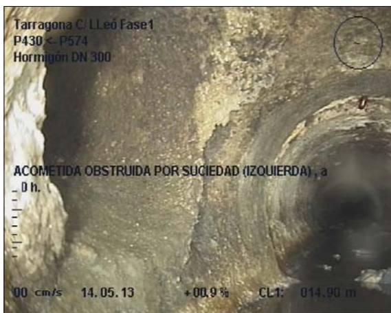
Foto: 6_12A, MPEG #: 140513_1, 00:05:39 14,9m, ACOMETIDA OBSTRUIDA POR SUCIEDAD (IZQUIERDA) , a 10 h.
