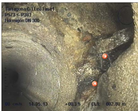
Foto: 3_3A, MPEG #: 140513_1, 00:01:02 2,8m, ACOMETIDA LADO DERECHO EN MAL ESTADO, cn fisuras filtraciones, a 2 h.
