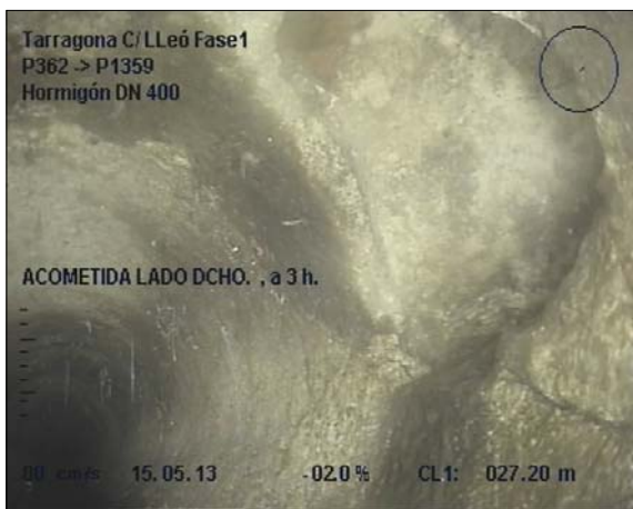
Foto: 21_12A, MPEG #: 140513_1, 00:03:58 27,2m, ACOMETIDA LADO DCHO. , a 3 h.
