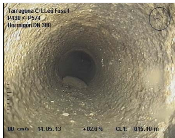
Foto: 6_12B, MPEG #: 140513_1, 00:05:39 14,9m, ACOMETIDA OBSTRUIDA POR SUCIEDAD (IZQUIERDA) , a 10 h.
