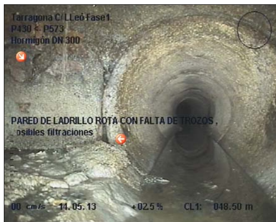
Foto: 2_14A, MPEG #: 140513_1, 00:05:42 48,5m, PARED DE LADRILLO ROTA CON FALTA DE TROZOS , posibles filtraciones
