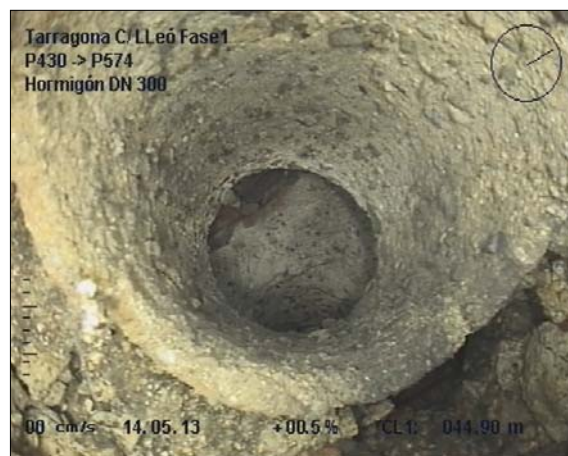
Foto: 1_10B, MPEG #: 140513_1, 00:04:53 44,8m, ACOMETIDA LADO DERECHO EN MAL ESTADO, con roturas GRAVES, a 3 h.
