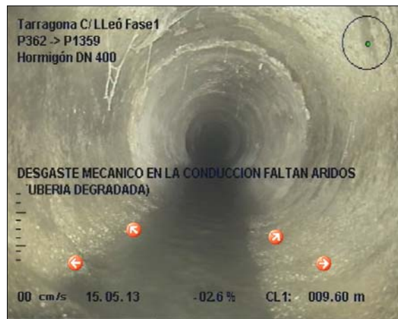
Foto: 20_4A, MPEG #: 140513_1, 00:01:04 9,6m, DESGASTE MECANICO EN LA CONDUCCION FALTAN ARIDOS (TUBERIA DEGRADADA)
