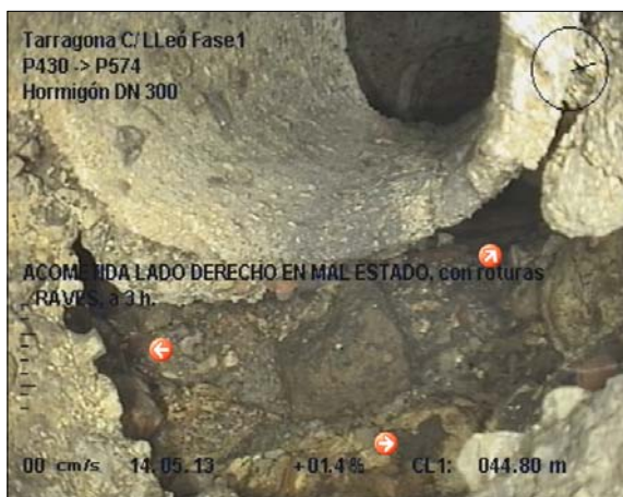
Foto: 1_10A, MPEG #: 140513_1, 00:04:53 44,8m, ACOMETIDA LADO DERECHO EN MAL ESTADO, con roturas GRAVES, a 3 h.
