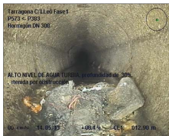
Foto: 3_6A, MPEG #: 140513_1, 00:03:07 12,9m, ALTO NIVEL DE AGUA TURBIA, profundidad de 30%, retenida por obstrucción
