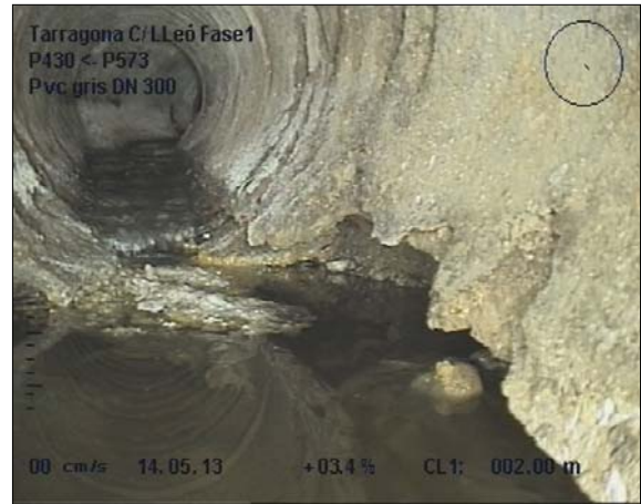
Foto: 5_4B, MPEG #: 140513_1, 00:00:39 1,5m, ROTURA PUNTUAL CON PERDIDA DE MATERIAL , parte inferior FILTRACIONES GRAVES
