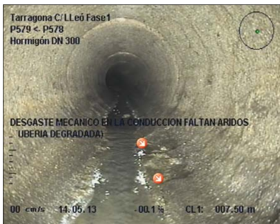
Foto: 10_5A, MPEG #: 140513_1, 00:01:21 7,5m, DESGASTE MECANICO EN LA CONDUCCION FALTAN ARIDOS (TUBERIA DEGRADADA)
