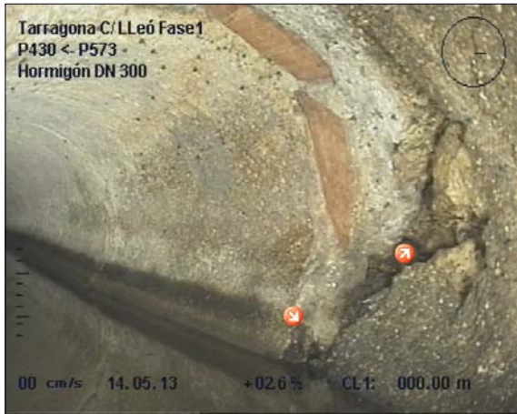
Foto: 2_3A, MPEG #: 140513_1, 00:00:08 0,3m, ROTURA PUNTUAL , con filtraciones
