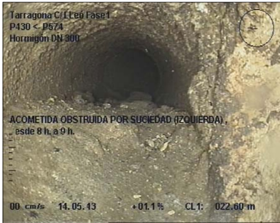
Foto: 6_16A, MPEG #: 140513_1, 00:07:33 22,6m, ACOMETIDA OBSTRUIDA POR SUCIEDAD (IZQUIERDA) , desde 8 h. a 9 h.
