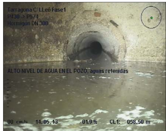
Foto: 1_19A, MPEG #: 140513_1, 00:09:00 58,5m, ALTO NIVEL DE AGUA EN EL POZO, aguas retenidas
