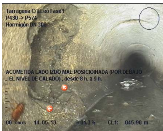
Foto: 1_11A, MPEG #: 140513_1, 00:05:23 45,9m, ACOMETIDA LADO IZDO MAL POSICIONADA (POR DEBAJO DEL NIVEL DE CALADO) , desde 8 h. a 9 h.
