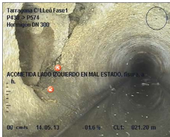
Foto: 1_4A, MPEG #: 140513_1, 00:00:45 21,2m, ACOMETIDA OBSTRUIDA POR SUCIEDAD (IZQUIERDA) , a 9 h.
