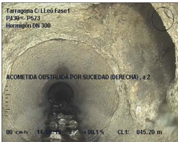
Foto: 2_11A, MPEG #: 140513_1, 00:04:32 45,2m, ACOMETIDA OBSTRUIDA POR SUCIEDAD (DERECHA) , a 2 h.
