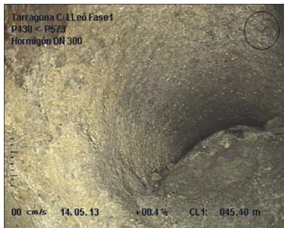
Foto: 2_11B, MPEG #: 140513_1, 00:04:32 45,2m, ACOMETIDA OBSTRUIDA POR SUCIEDAD (DERECHA) , a 2 h.
