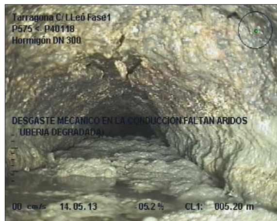
Foto: 9_5A, MPEG #: 140513_1, 00:02:09 5,2m, DESGASTE MECANICO EN LA CONDUCCION FALTAN ARIDOS (TUBERIA DEGRADADA)
