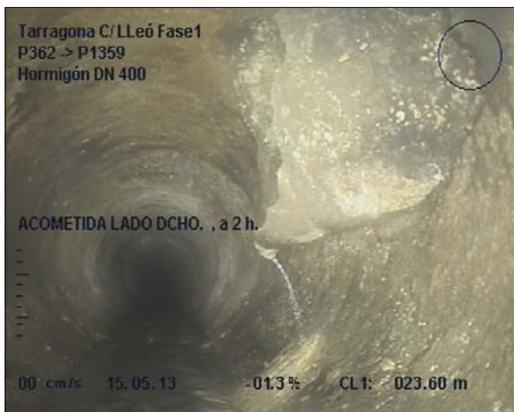
Foto: 21_10A, MPEG #: 140513_1, 00:03:24 23,6m, ACOMETIDA LADO DCHO. , a 2 h.
