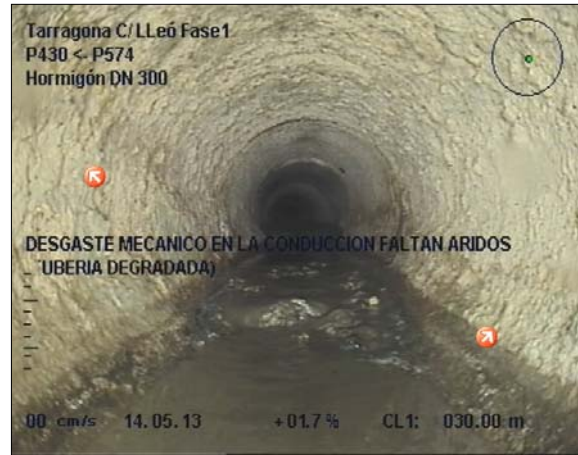
Foto: 6_17A, MPEG #: 140513_1, 00:08:23 30m, DESGASTE MECANICO EN LA CONDUCCION FALTAN ARIDOS (TUBERIA DEGRADADA)
