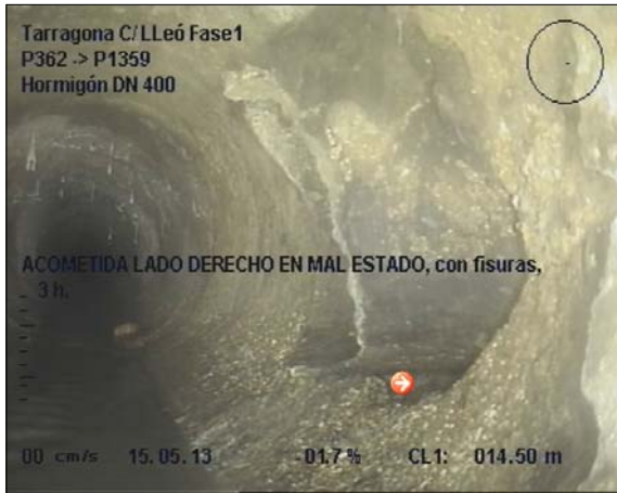
Foto: 20_7A, MPEG #: 140513_1, 00:01:57 14,5m, ACOMETIDA LADO DERECHO EN MAL ESTADO, con fisuras, a 3 h.
