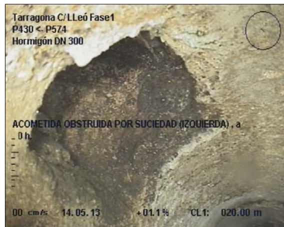
Foto: 6_14A, MPEG #: 140513_1, 00:06:46 20m, ACOMETIDA OBSTRUIDA POR SUCIEDAD (IZQUIERDA) , a 10 h.
