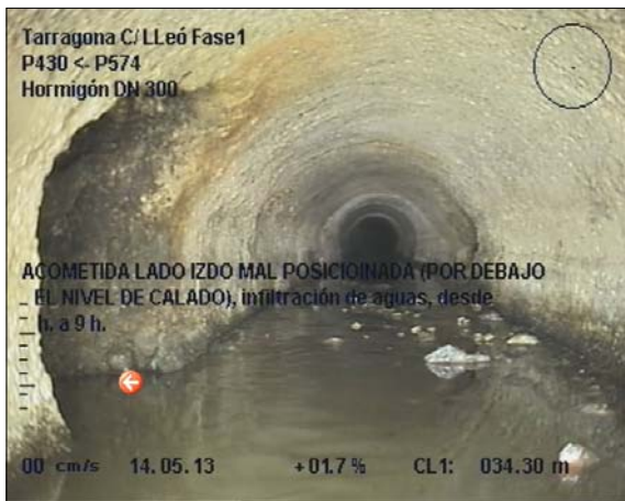
Foto: 6_18A, MPEG #: 140513_1, 00:09:01 34,6m, ACOMETIDA LADO IZDO MAL POSICIONADA (POR DEBAJO DEL NIVEL DE CALADO), infiltración de aguas, desde 8 h. a 9 h.
