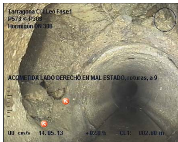
Foto: 3_4A, MPEG #: 140513_1, 00:00:30 2,9m, ACOMETIDA LADO DERECHO EN MAL ESTADO, roturas, a 9 h.
