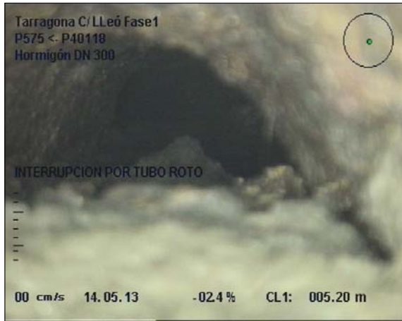
Foto: 9_6A, MPEG #: 140513_1, 00:02:39 5,2m, INTERRUPCION POR TUBO ROTO G-P575
