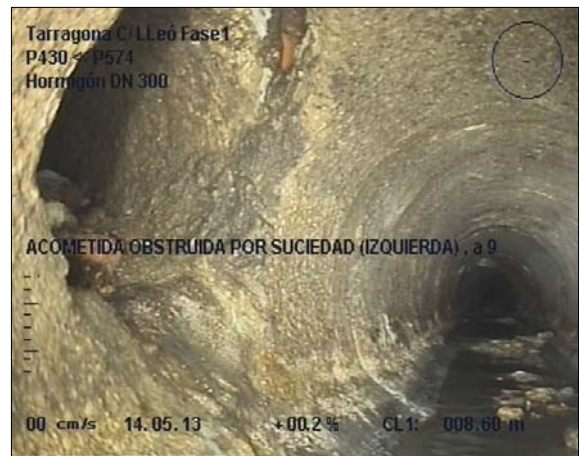
Foto: 6_10A, MPEG #: 140513_1, 00:04:11 8,6m, ACOMETIDA OBSTRUIDA POR SUCIEDAD (IZQUIERDA) , a 9 h.
