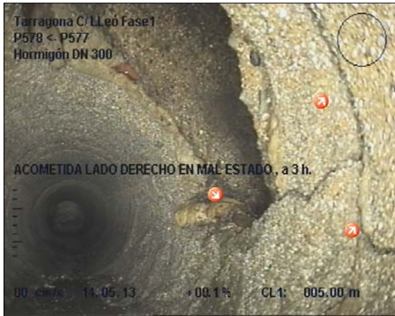
Foto: 11_7A, MPEG #: 140513_1, 00:01:08 5m, ACOMETIDA LADO DERECHO EN MAL ESTADO , a 3 h.
