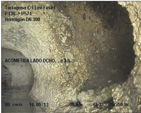
Foto: 1_16A, MPEG #: 140513_1, 00:07:46 57,9m, ACOMETIDA OBSTRUIDA POR SUCIEDAD (DERECHA) , a 3 h.
