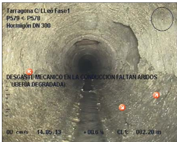
Foto: 10_3A, MPEG #: 140513_1, 00:00:27 2,2m, DESGASTE MECANICO EN LA CONDUCCION FALTAN ARIDOS (TUBERIA DEGRADADA)
