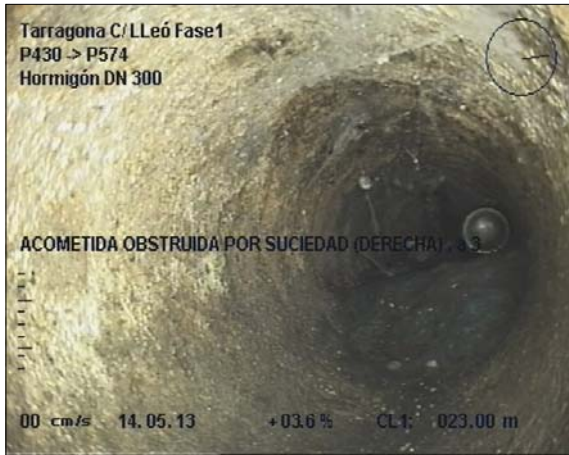
Foto: 1_6A, MPEG #: 140513_1, 00:01:41 23m, ACOMETIDA OBSTRUIDA POR SUCIEDAD (DERECHA) , a 3 h.
