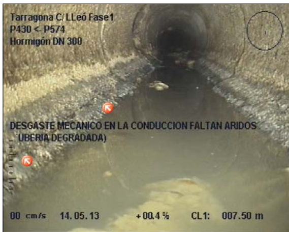
Foto: 6_9A, MPEG #: 140513_1, 00:03:42 7,5m, DESGASTE MECANICO EN LA CONDUCCION FALTAN ARIDOS (TUBERIA DEGRADADA)
