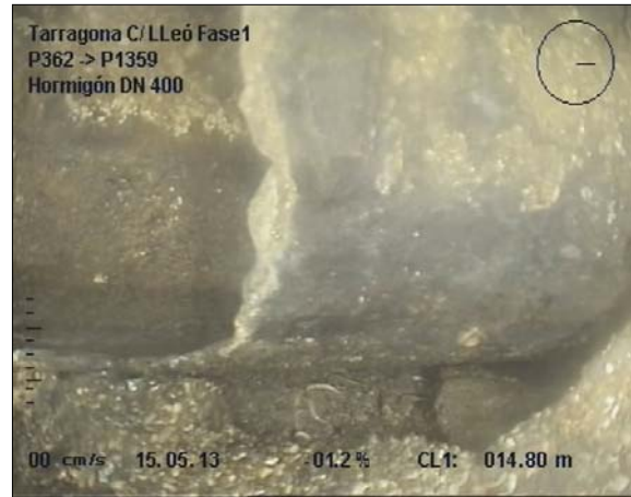
Foto: 21_7B, MPEG #: 140513_1, 00:01:57 14,5m, ACOMETIDA LADO DERECHO EN MAL ESTADO, con fisuras, a 3 h.
