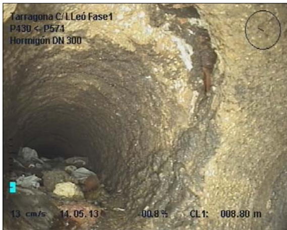
Foto: 6_10B, MPEG #: 140513_1, 00:04:11 8,6m, ACOMETIDA OBSTRUIDA POR SUCIEDAD (IZQUIERDA) , a 9 h.
