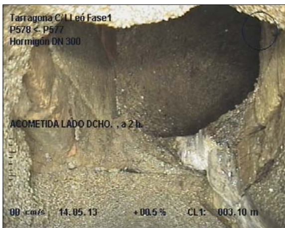
Foto: 12_5A, MPEG #: 140513_1, 00:00:40 3,1m, ACOMETIDA LADO DCHO., a 2 h.
