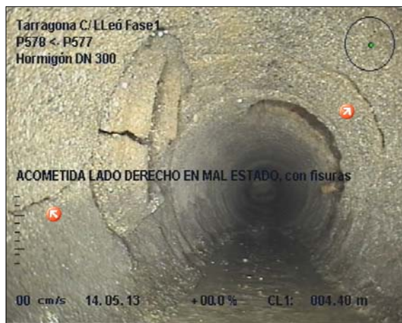
Foto: 11_6A, MPEG #: 140513_1, 00:00:55 4,4m, ACOMETIDA LADO DERECHO EN MAL ESTADO, con fisuras
