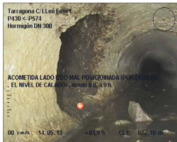
Foto: 6_15A, MPEG #: 140513_1, 00:07:17 22,6m, ACOMETIDA LADO IZDO MAL POSICIONADA (POR DEBAJO DEL NIVEL DE CALADO) , desde 8 h. a 9 h.
