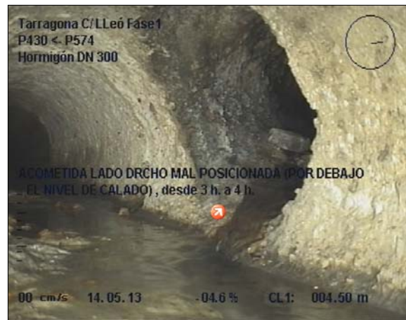
Foto: 6_6A, MPEG #: 140513_1, 00:02:03 4,5m, ACOMETIDA LADO DRCHO MAL POSICIONADA (POR DEBAJO DEL NIVEL DE CALADO) , desde 3 h. a 4 h.
