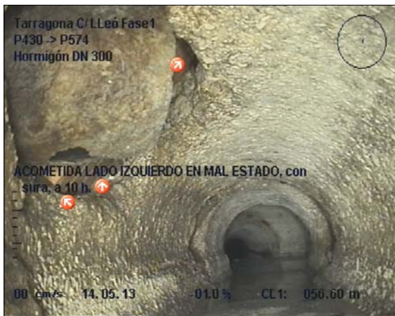
Foto: 1_14A, MPEG #: 140513_1, 00:07:07 56,6m, ACOMETIDA LADO IZQUIERDO EN MAL ESTADO, con fisura, a 10 h.
