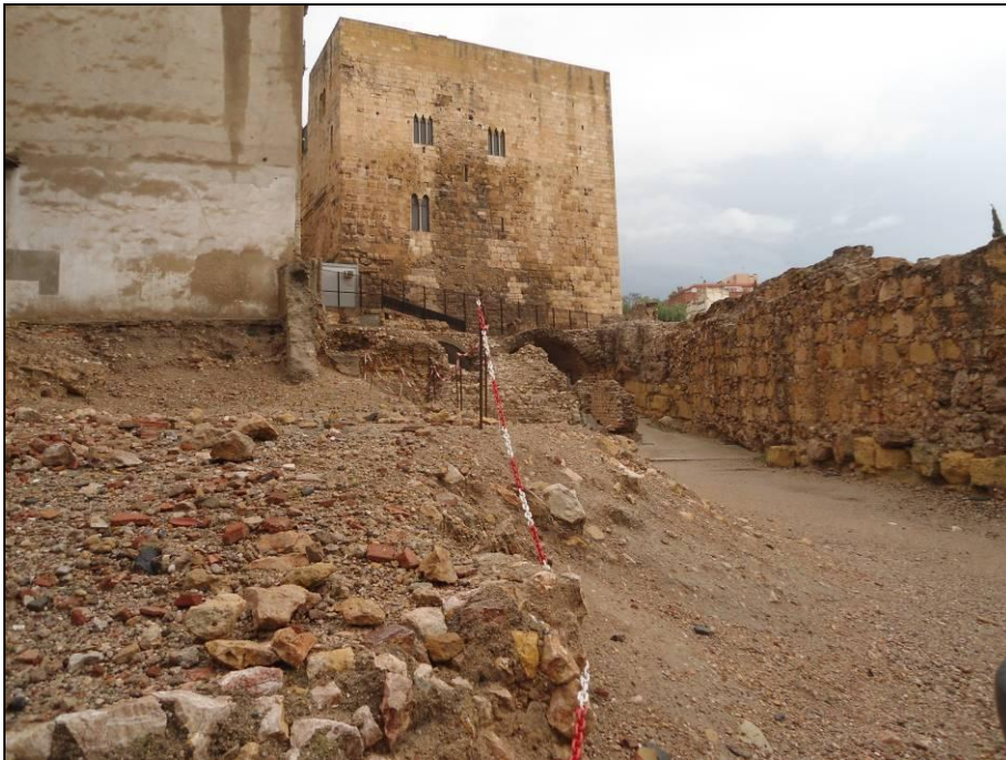
11. Detalle frontal del sector B, con el perfil a rebajar y consolidar del lado W (a la izquierda), antes de comenzar los trabajos.
