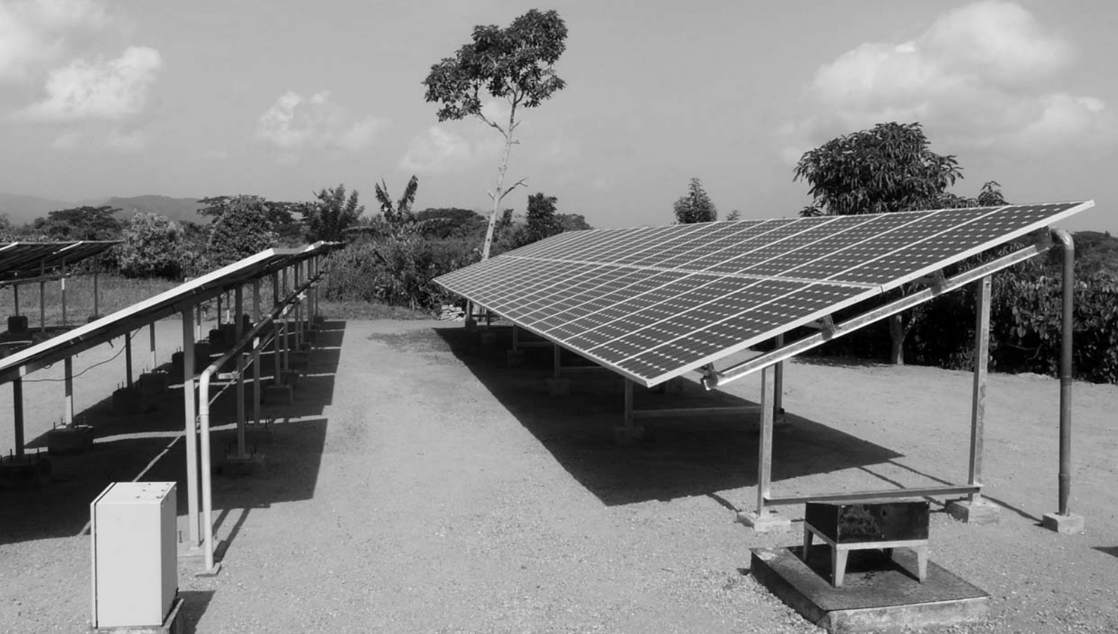
Projecte 1981. Mejora técnica de la central fotovoltaica de Santa María del Loreto, 3ª parte (Cuba). Casal d'Amistat amb Cuba de Badalona
